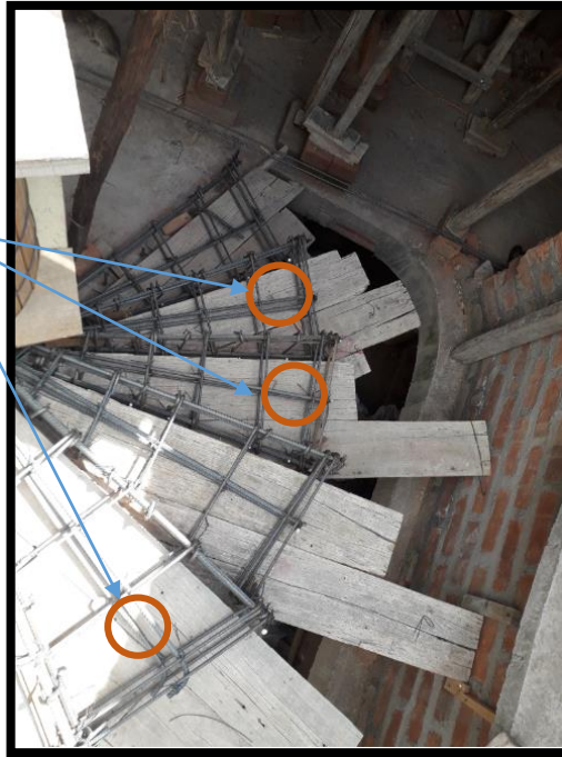
Fotografía 1. Peldaños en voladizo. Fuente propia
