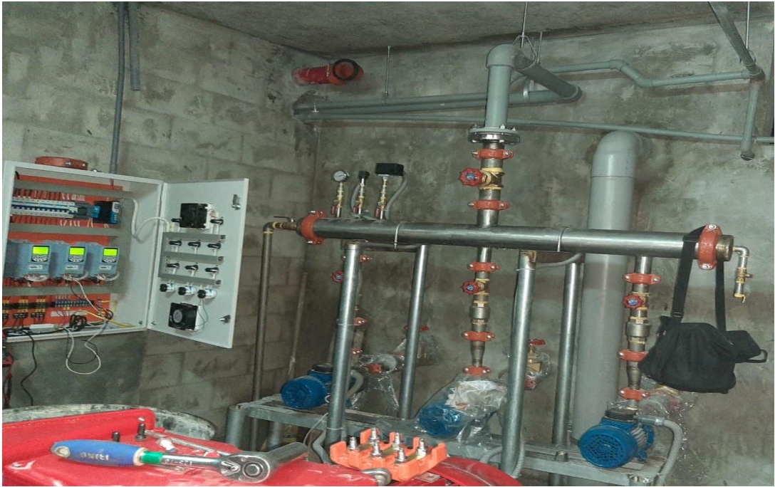
Fotografía 1. Visualización del sistema de bombeo ya ejecutado.
