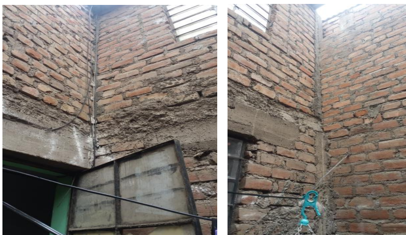
Figura 48: Muros Artesanales no tienen columna amarre
