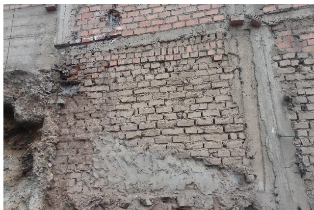
Figura 50: Vivienda de 3, Acero Corroído y contacto con agua
