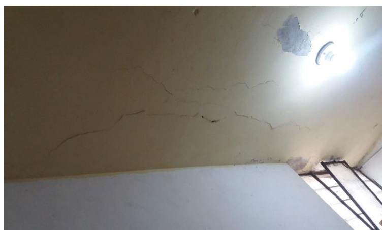
Figura 60: Diafragmas Horizontales con Fallas
