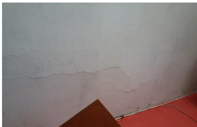
Figura 59: Diafragmas Horizontales con Fallas
