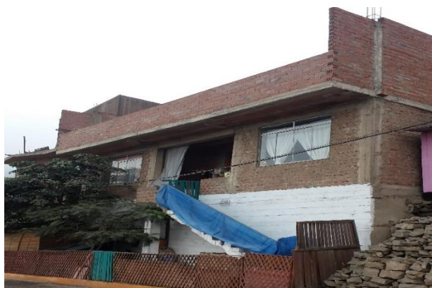
Figura 71: Viviendas Construida con elemento estructural no confinado
