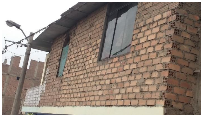
Figura 67: Viviendas Construida Sin Columnas
