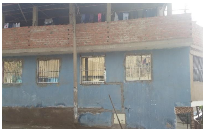
Figura 72: Viviendas Construida con elemento estructural no confinado
