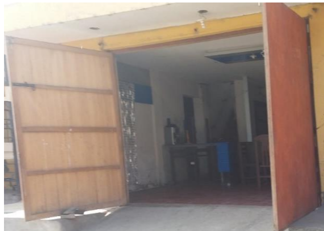
Figura 53: Vivienda sin Confinamiento en la parte más corta
