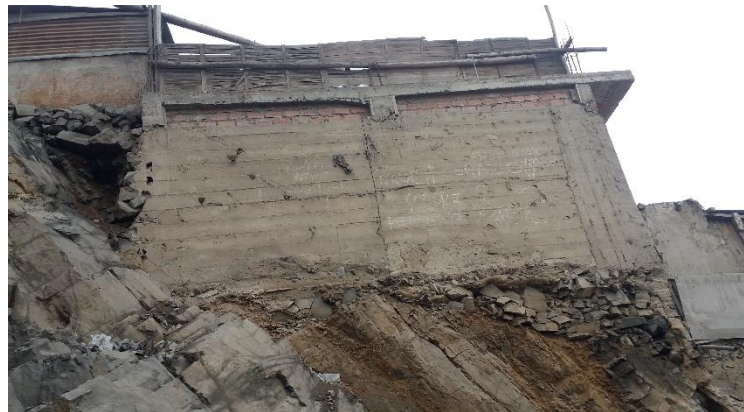
Figura 55: Cimentación de una vivienda en alto riesgo
