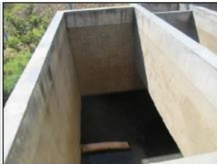
Figura N°: 15,16 – Estado Situacional del Tanque Imhoff. Fuente: Elaboración Propia.
