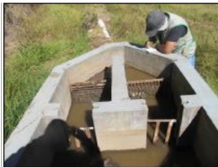
Figura N°: 14 – Estado Situacional de la Cámara de Rejas. Fuente: Elaboración Propia.
