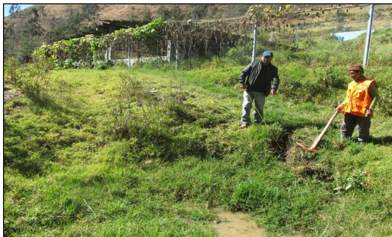
Figura N°:18 – Estado Situacional del Filtro Biológico. Fuente: Elaboración Propia.
