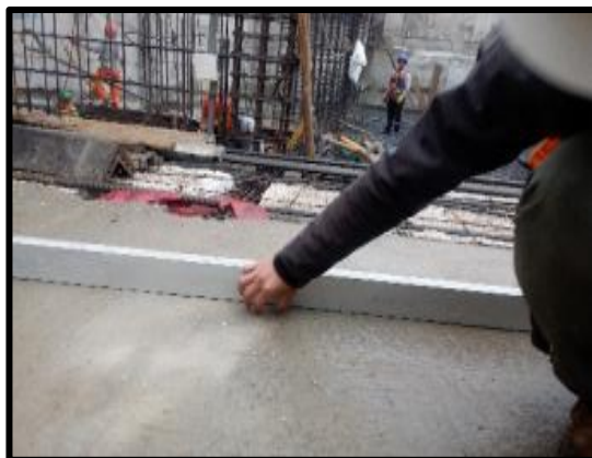
FOTOGRAFIA N°63. SE VISUALIZA QUE EL ERROR EN EL ACABADO DEL PISO FROTACHADO ES MINIMO Y ES ACEPTABLE DENTRO DE LO TOLERABLE DE +-3mm-
