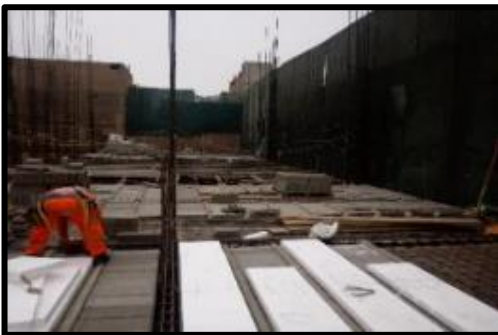
FOTOGRAFIA N°51. ORDEN DE LOS MATERIALES Y EL ADECUADO PROCESO DE COLOCACION DE LOS BANDEJAS
