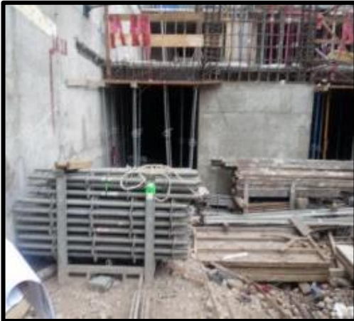
FOTOGRAFIA N°50. ORDEN DE LOS MATERIALES Y EL ADECUADO PROCESO DE COLOCACION DE PUNTALES.
