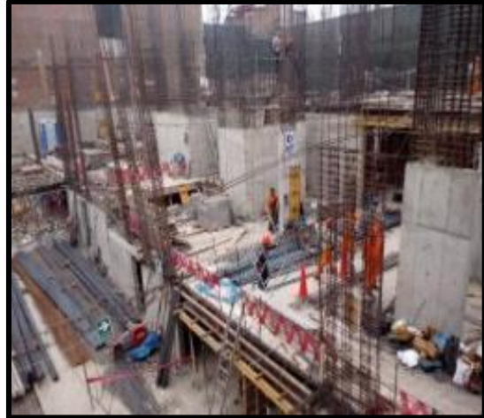
FOTOGRAFIA N°53. ORDEN DE LOS MATERIALES Y EL ADECUADO PROCESO DE COLOCACION DE LOS ACEROS.
