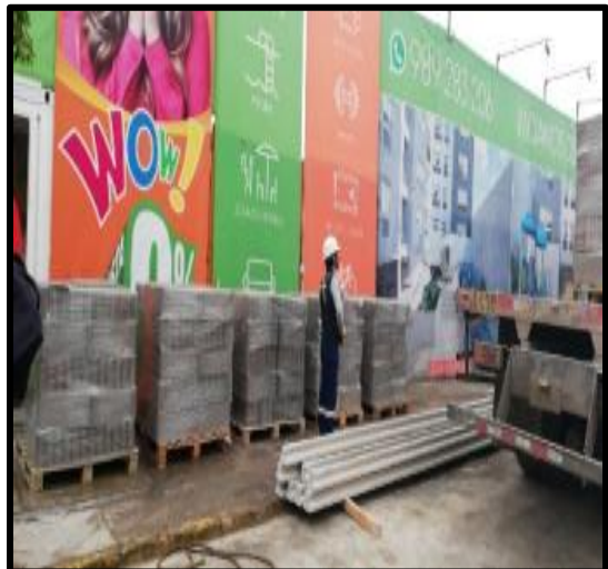
FOTOGRAFIA N°55. ORDEN DE LOS MATERIALES Y EL ADECUADO PROCESO DE COLOCACION DE LOS BANDEJAS.
