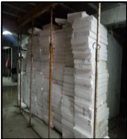
FOTOGRAFIA N°52. ORDEN DE LOS MATERIALES Y EL ADECUADO PROCESO DE COLOCACION DE LOS POLIESTIRENOS.
