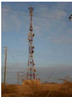
Figura 14: Infraestructura de telecomunicaciones Autosoportadas
