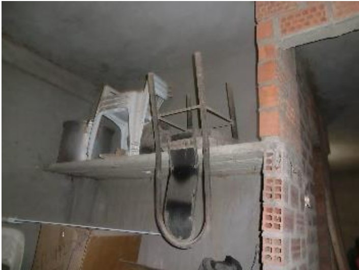
Figura 20: Incorrecto uso del ladrillo de albañilería
