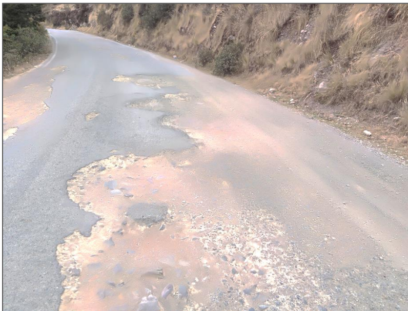
Figura 19. Estado de la vía de la M-4. Elaboración propia, 2019.
