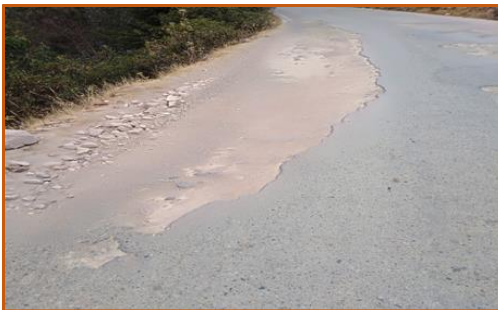
Figura 8. Desprendimiento de borde de alta severidad de la M-11. Elaboración propia, 2019.
