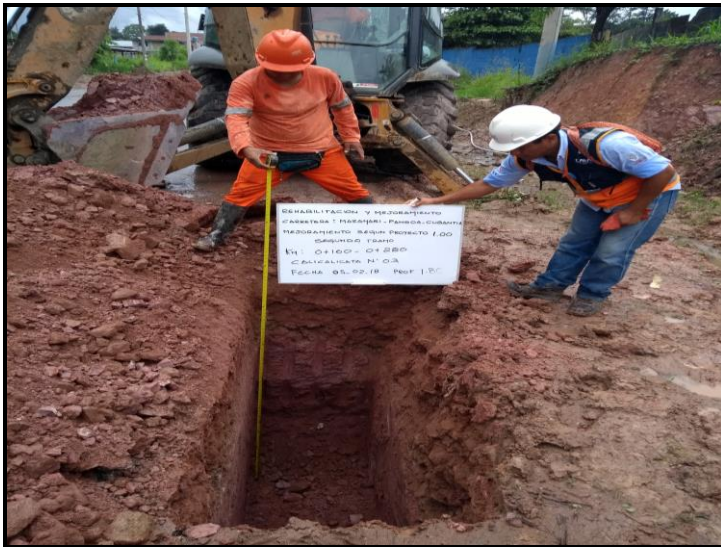
Fig. 02. Calicata en el sector km. 0+160 a km 0+280, muestreo km. 0+200, profundidad 1.80 m, L. Der.
