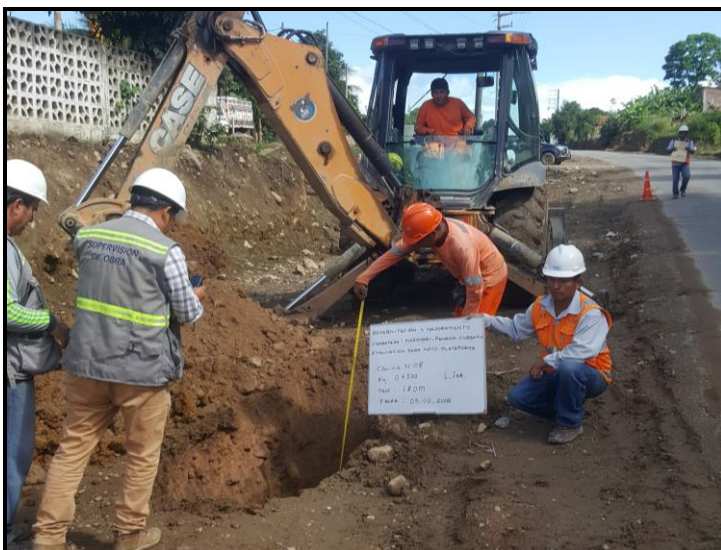
Fig. 03. Calicata en el sector km. 0+450 a km 0+680, muestreo km. 0+500, profundidad 1.80 m, L. Izq.
