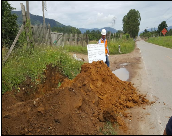
Fig. 04. Calicata en el sector km. 1+960 a km 2+120, muestreo km. 2+000, profundidad 2.40 m, L. Der.
