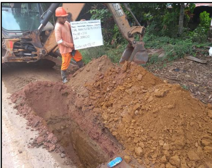
Fig. 12. Calicata en el sector km. 8+260 a km 8+300, muestreo km. 8+300, profundidad 1.50 m, L. Der.
