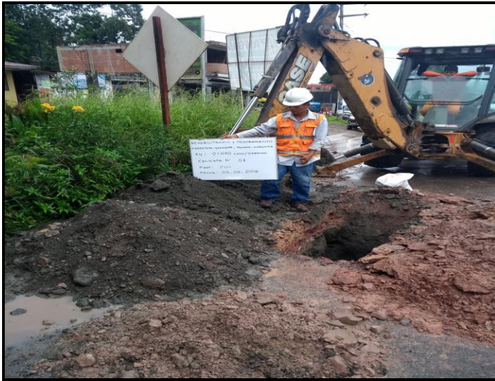
Fig. 01. Calicata en el sector km. 0+032 a km 0+120, muestreo km. 0+040, profundidad 2.00 m, L. Der.
