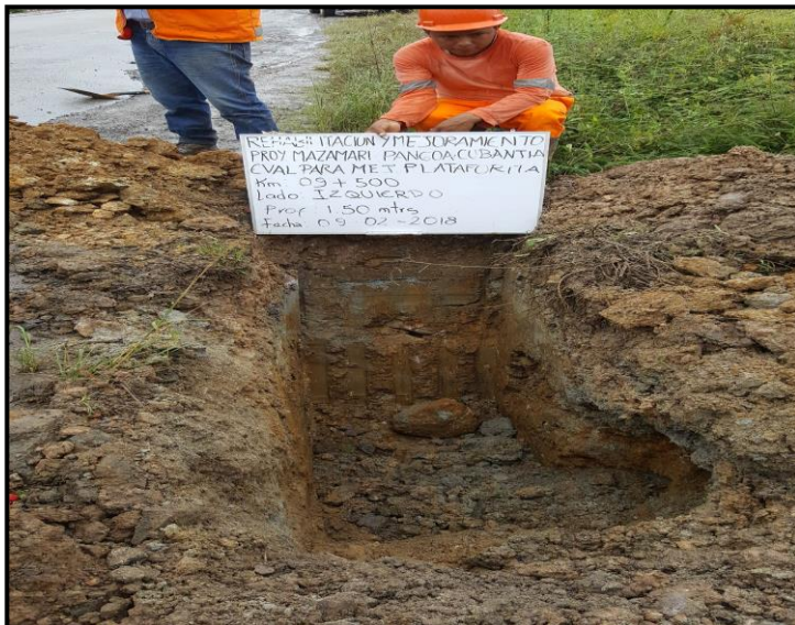
Fig. 14. Calicata en el sector km. 9+400 a km 9+550, muestreo km. 9+500, profundidad 1.50 m, L. Izq.
