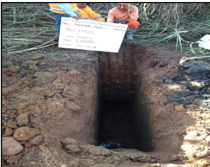
Fig. 06. Calicata en el sector km. 3+360 a km 3+510, muestreo km. 3+500, profundidad 2.00 m, L. Der.
