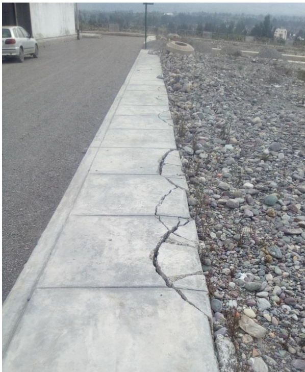
Fotografía 03. Veredas dañadas en la calle Moreras. (Fuente Propia)
