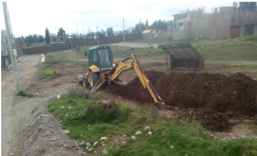
Fotografía. 14. Llegada de zanja a la Urbanización- Paralización de obra por parte de la municipalidad por no llegar a una solución eficaz. (Fuente Propia)
