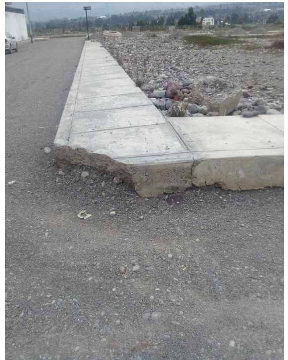
Fotografía 04. Encuentro de Veredas sin Martillo con estado malo. (Fuente Propia)
