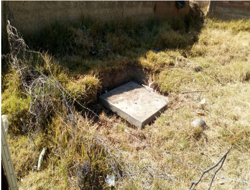
FIGURA N° 03: Caja de inspección.
