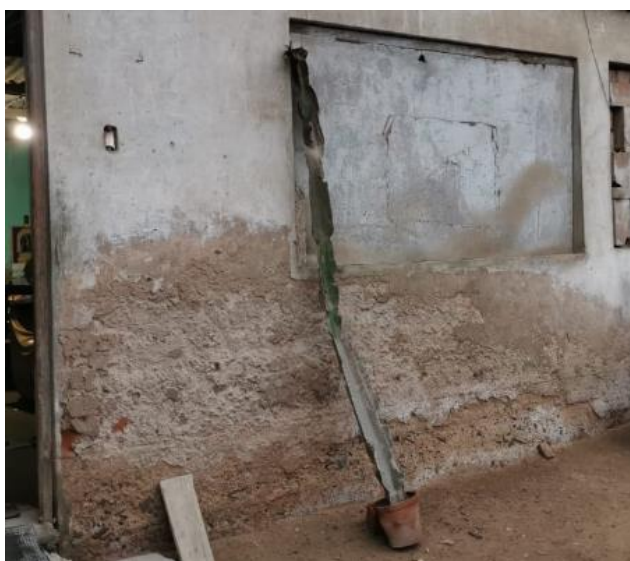
Figura 25. Eflorescencia en muro de primer nivel.
