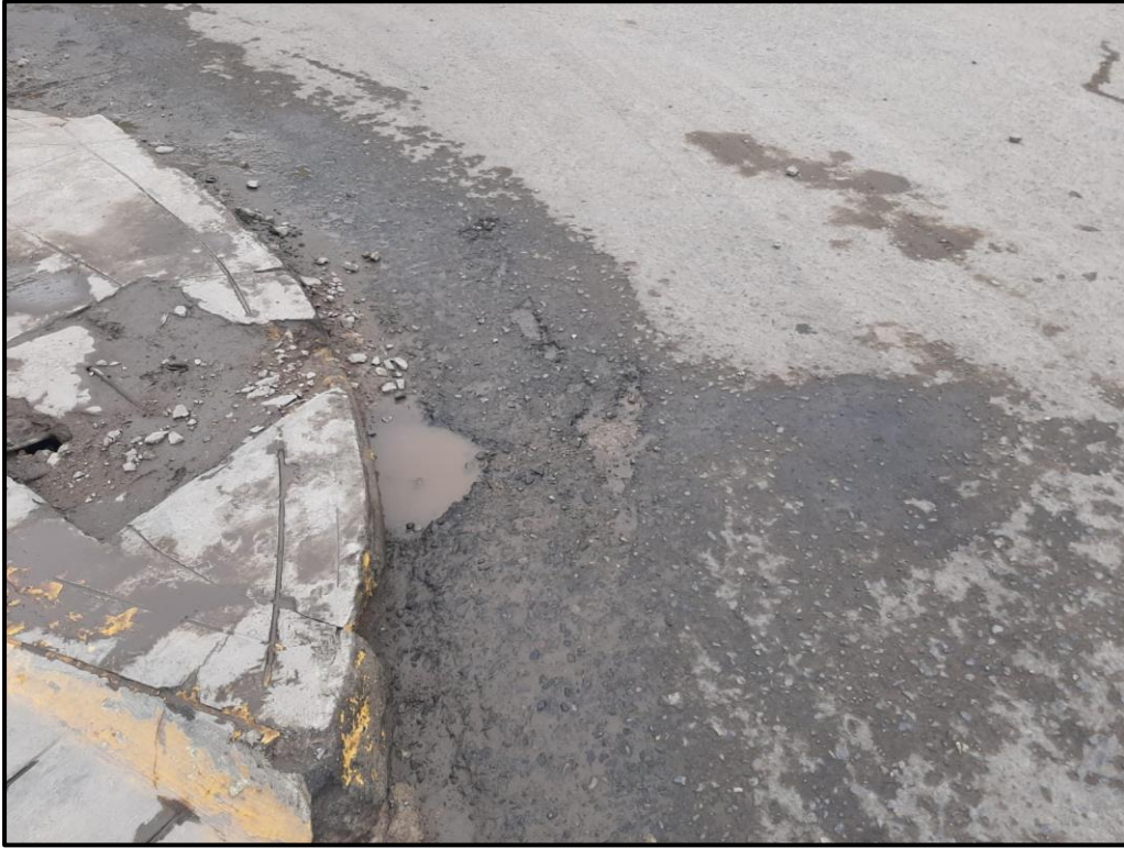
Foto 7 En la imagen se puede apreciar la falla grieta de borde
