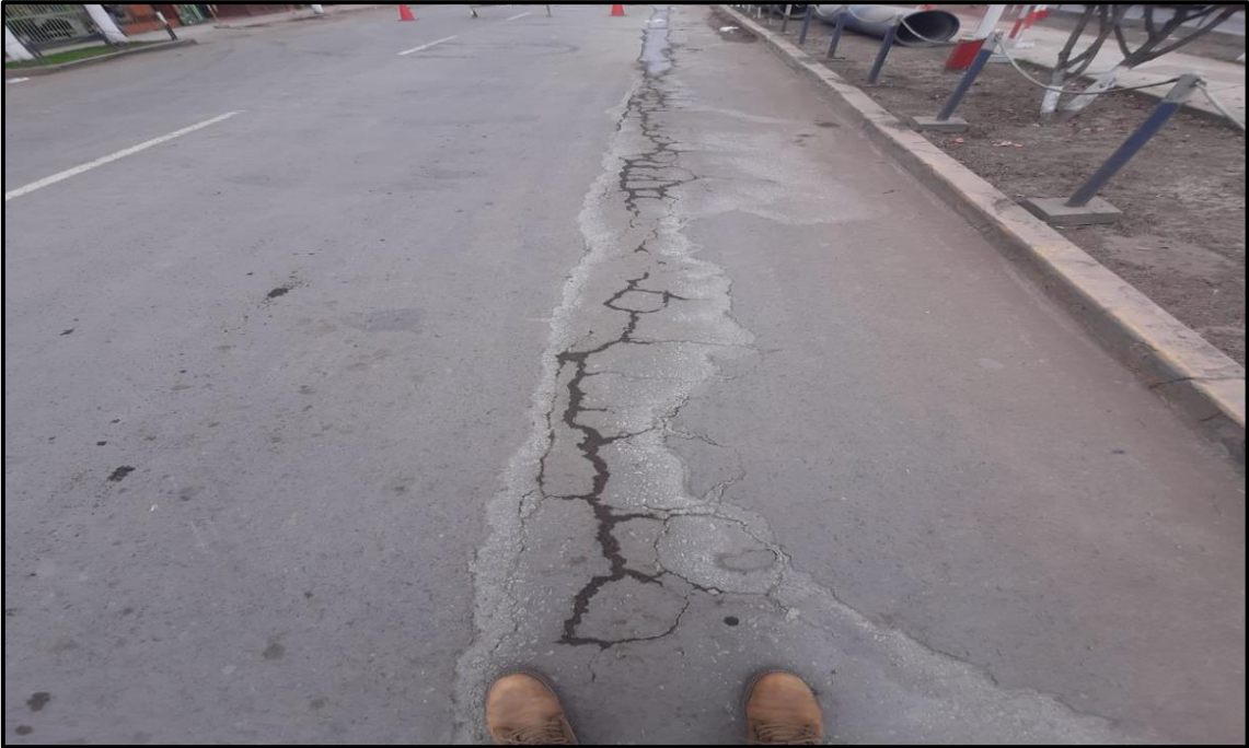
Foto 5 En la imagen se puede apreciar grietas longitudinales
