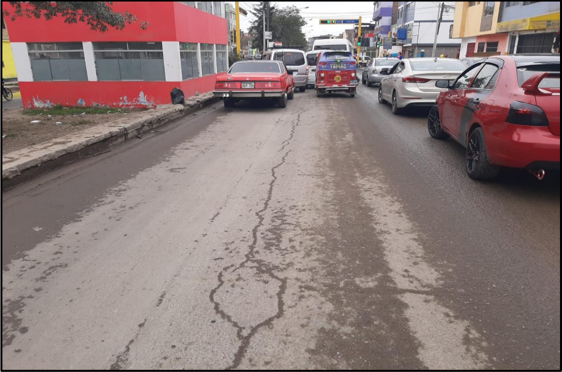
Foto 6 En la imagen se puede apreciar grietas transversales y longitudinales
