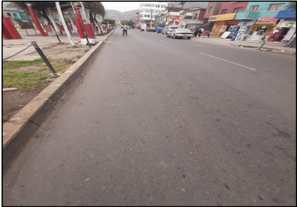
Foto 3 En la imagen se puede apreciar grietas longitudinales
