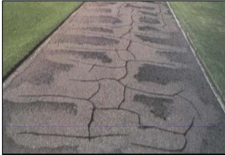
Figura 3 Grietas de Contracción Fuente: Elaboración propia
