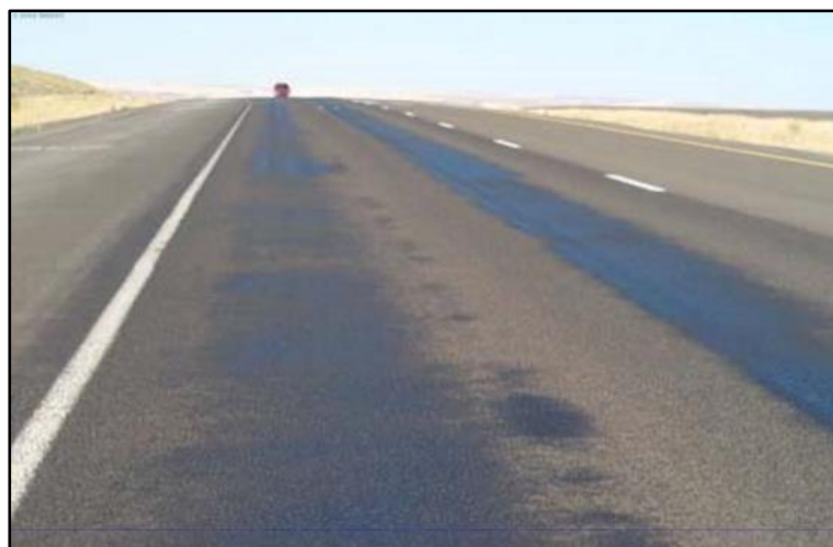
Figura 5 Manchas en Pavimento Fuente: Elaboración Propia
