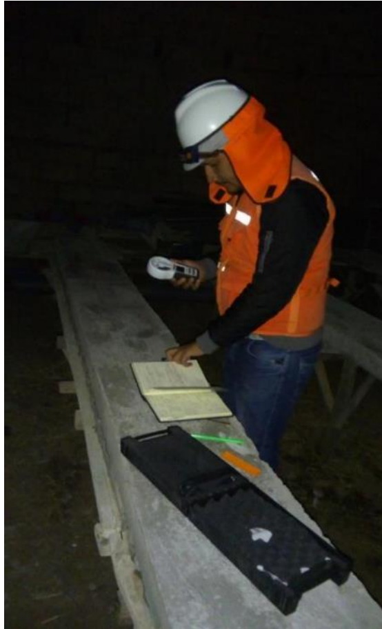
Control de fisuras con equipo meteorológico.
