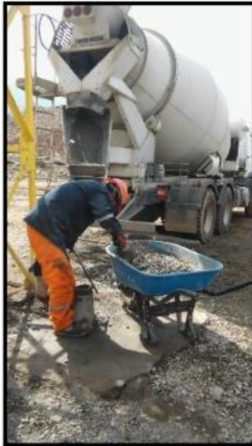
FIGURA N° 08: Ensayo de asentamiento previo a la salida del mixer, Colegio Santa Isabel.
