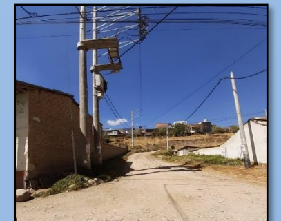
INGRESO VEHICULAR SIN INFRAESTRUCTURA
