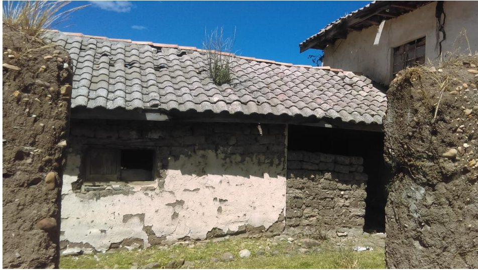
FOTO 9. Vivienda en adobe con fallas estructurales y desprendimiento de tarrajeo
