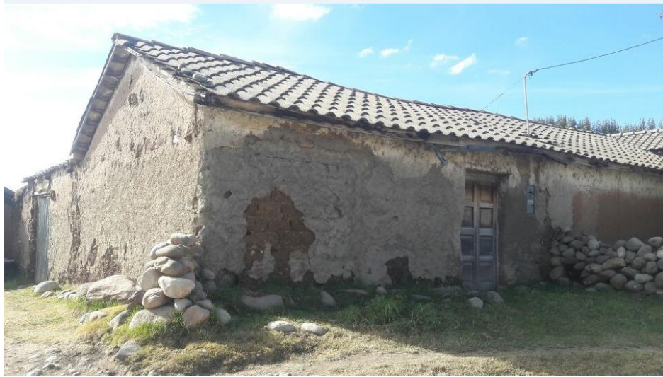
FOTO 7. Vivienda en adobe con deficiencias en los tarrajes
