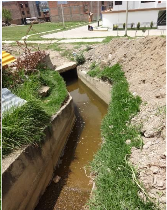
Foto 12: Canal de drenaje disminuido 0.80 m x 1.00 m Sector 01
