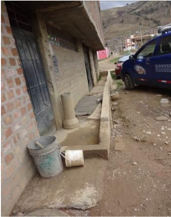
Foto 15: Barreras de protección contra lluvias Intensas Sector 02
