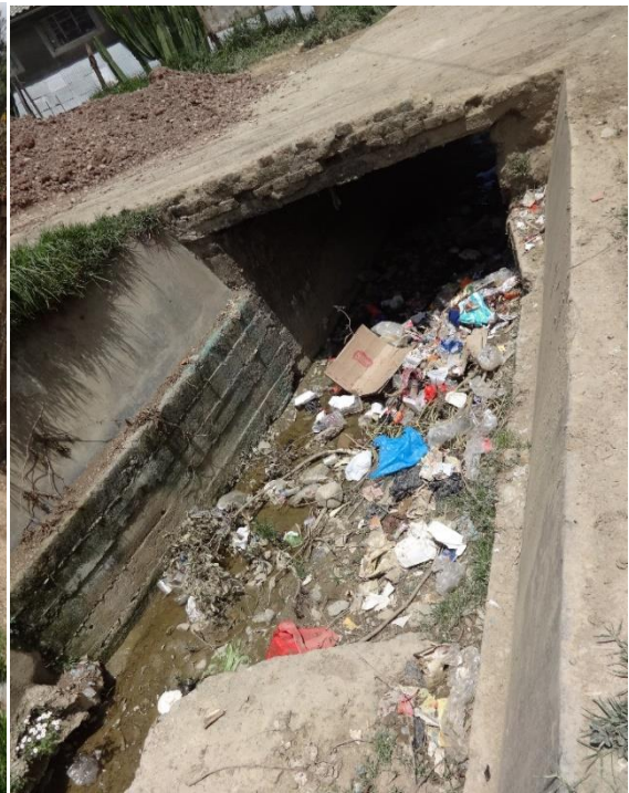
Foto 22: Acumulación de basura en quebrada 02 Sector 03
