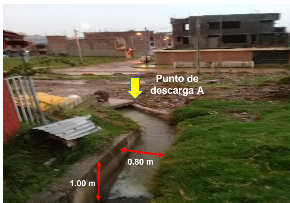
Foto 2: Curso de quebrada por canal estrangulado en su sección-Sector 01
