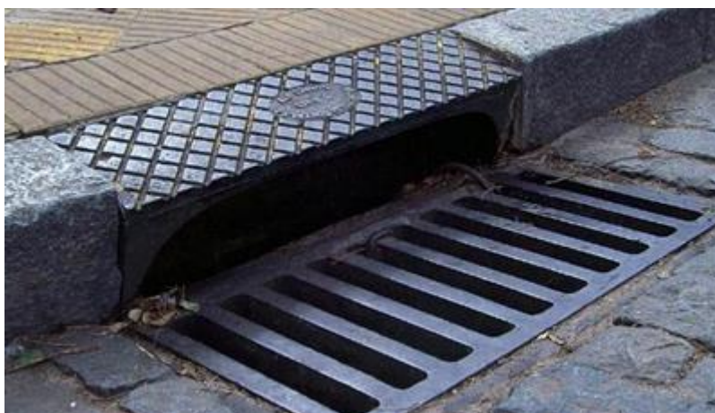
Figura 1 Recogida de aguas pluviales Fuente propia
