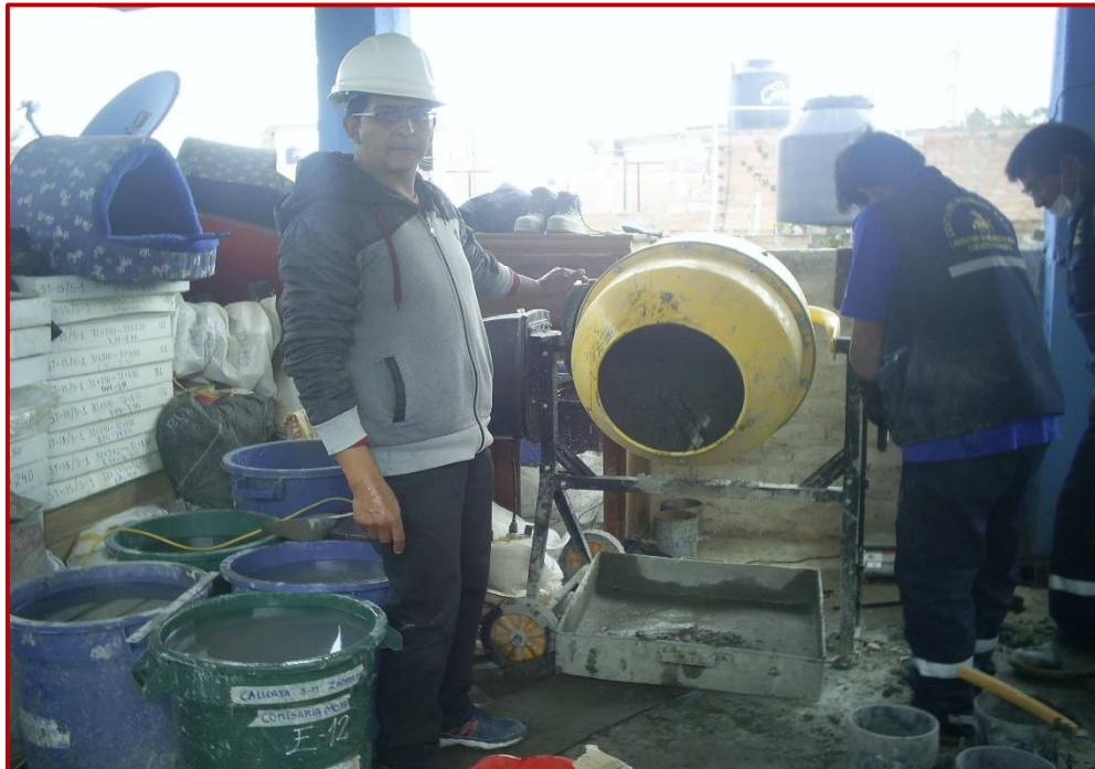
Fotografía N° 13: Elaboración de las 48 probetas de concreto de 210 Kg/cm 2 , siguiendo las especificaciones de la Norma Técnica Peruana.
