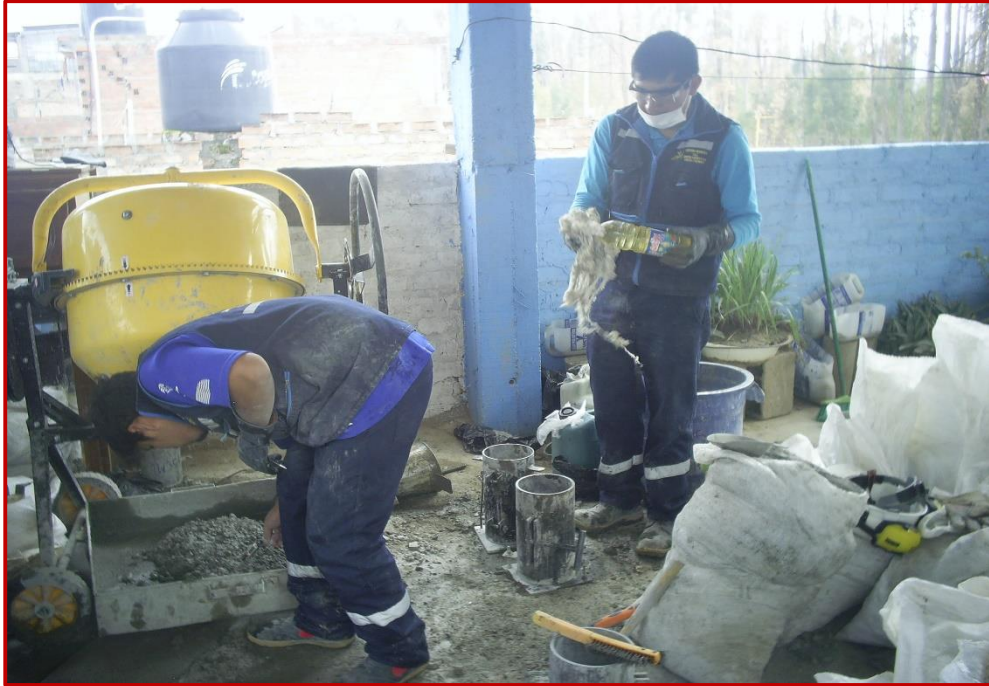
Fotografía N° 11: Verificando temperatura del concreto elaborado con agua tratada de las PTAR seleccionadas.
