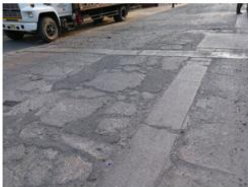
Imagen N° 03. Falla de losas divididas y parches grandes en el pavimento rígido en la cuadra 3 de la calle Luis Galvani.
