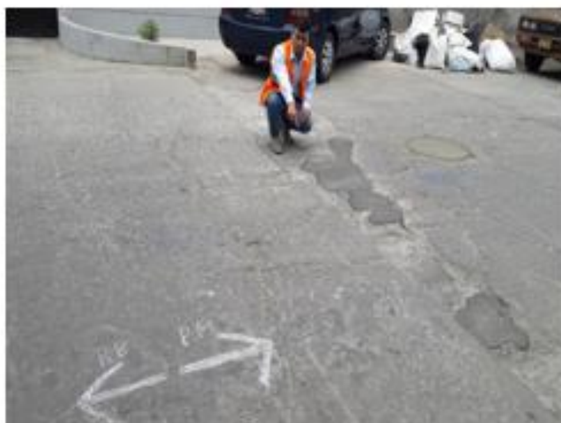
Imagen N° 04. Apreciación en el pavimento rígido en estado bueno y estado malo en la cuadra 2 de la calle Luis Galvani.
