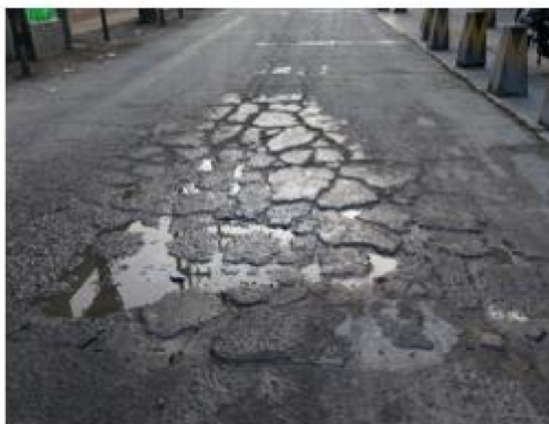
Imagen N° 02. Falla de losas divididas y acumulación de agua en el pavimento rígido en la cuadra 1 de la calle Luis Galvani.
