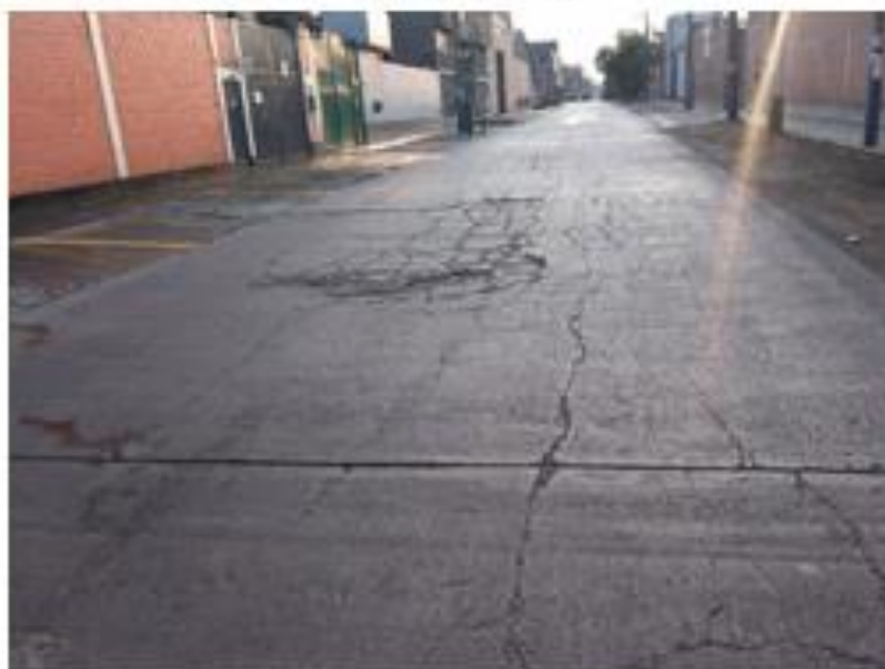
Imagen N° 01. Falla de losas divididas en el pavimento rígido en la cuadra 1 de la calle Luis Galvani.
