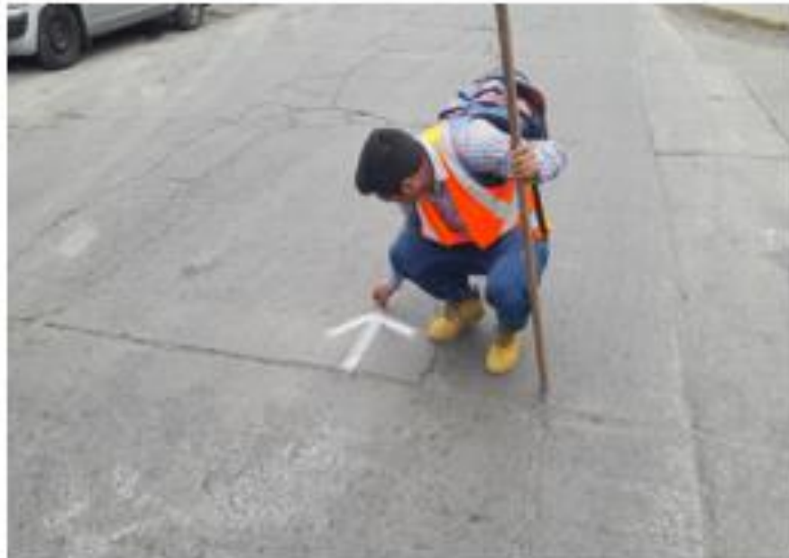
Imagen N° 05. Identificación de pavimento en mal estado en la cuadra 1 de la calle Luis Galvani.
