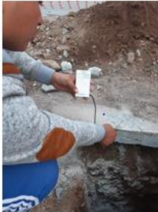
Imagen N° 35. Toma de la temperatura de la losa de concreto parte superior (día).
