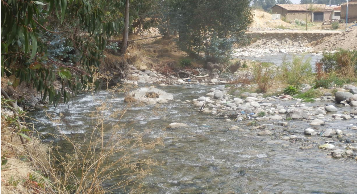
FOTO N° 05: Cauce del rio Achamayo y erosiones generadas.
