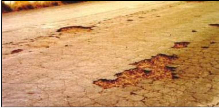
Figura N° 16. Desprendimiento del material de la base.
