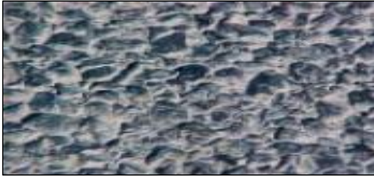
Figura N° 18. Desgaste de agregados.
