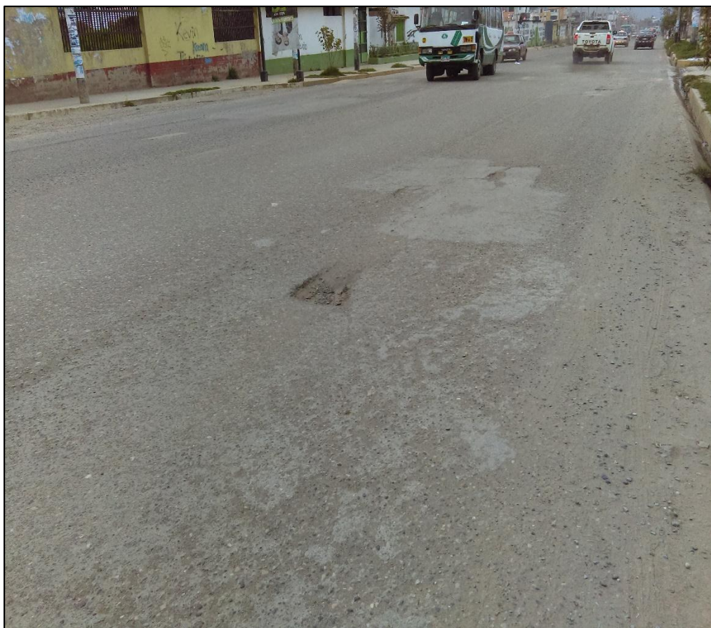
Figura N° 13. Condición actual de la vía en estudio.
