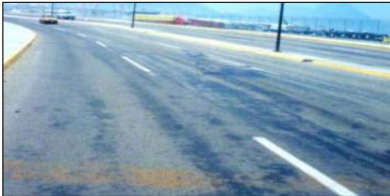
Figura N° 17. Exudación de asfalto.
