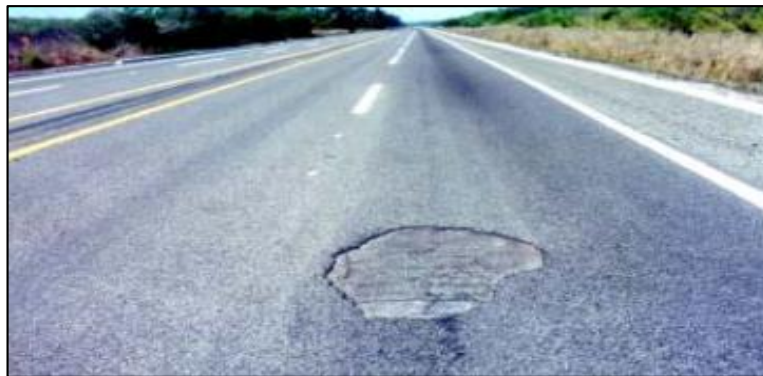
Figura N° 15. Pérdida de la capa de rodadura.
