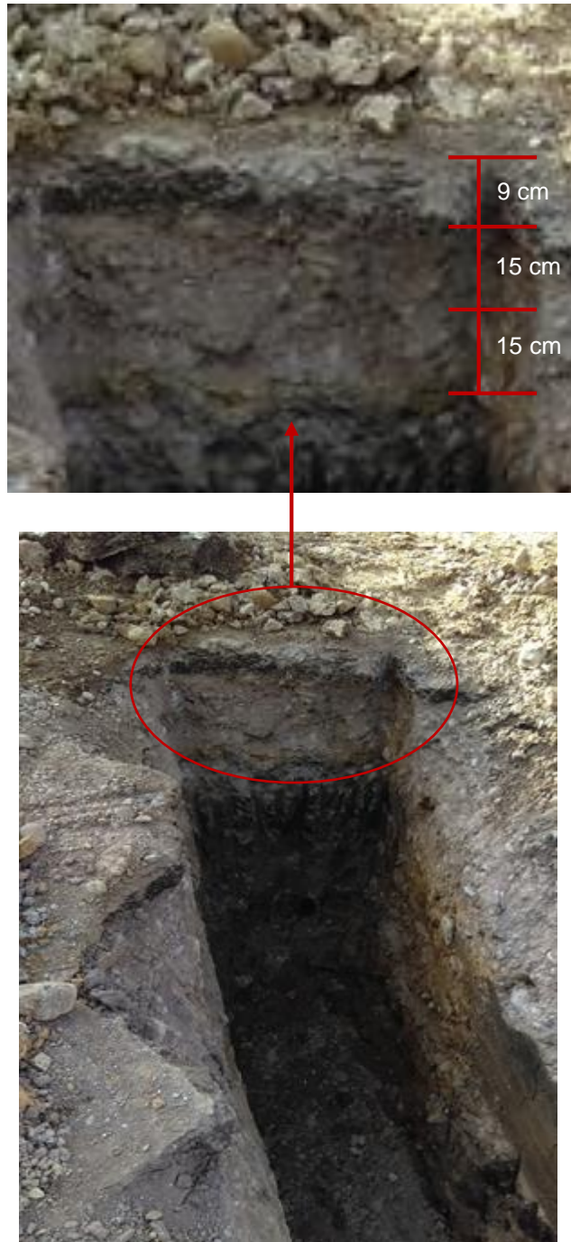
Figura N° 37. Sección transversal del pavimento de la Av. Calmell del solar y la Calle Urano
