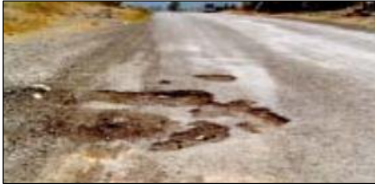
Figura N° 14. Pérdida en la superficie de los agregados.
