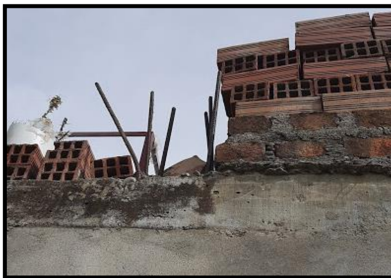
Figura 4.9 – Exposición de varillas de acero de columna.
