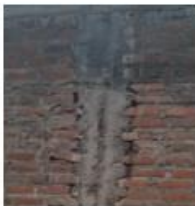
presencia de junta fria mano de obra mala calidad
