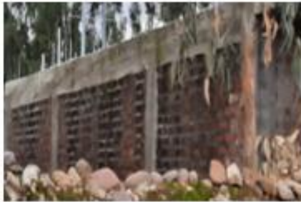
Humedad en murar
