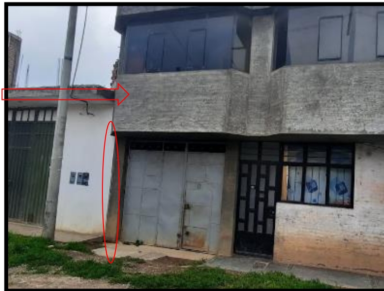
Figura 4.3 - Vivienda sin junta sísmica y desnivel de diafragma rígido
