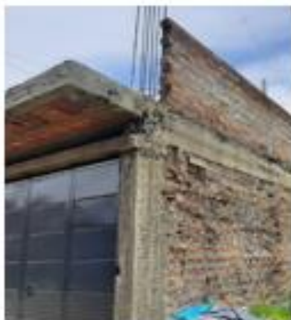
Canchero en columna acera opuerta por presencia de canchero mala calidad de mana de abra en arentada de mura
