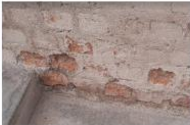
eflorescencia en murar por humedad
