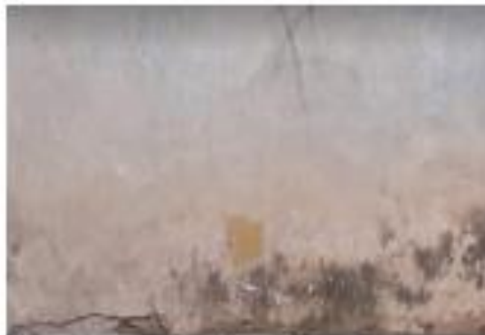
eflorescencia y humedad en abrocamiento
