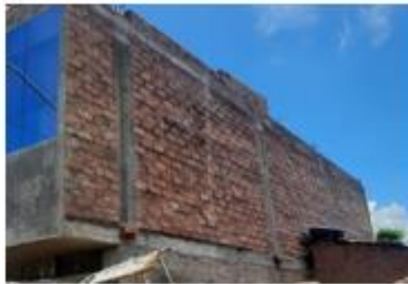
Mura partante con ladrilla pandorota
