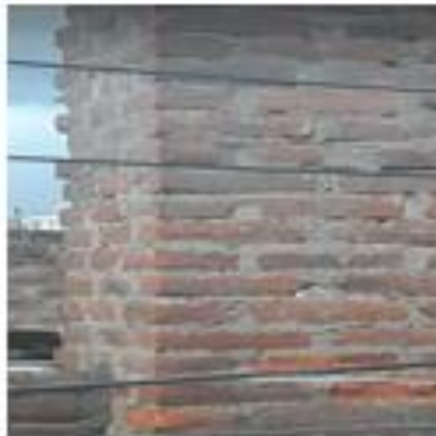
ladrillo artesanal en mal estado y muro no arriatado
