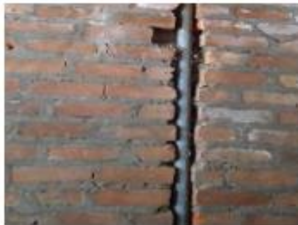
murar partante con tubería descubierta
