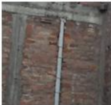
tuberia descubierto en murar
