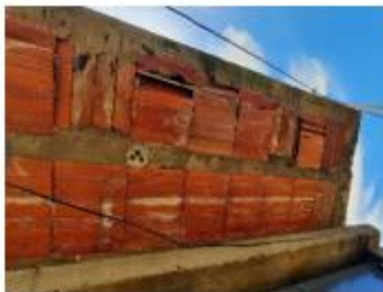
ladrillo de techa rajado, en mal ortada ladrillo artesanal en techa
