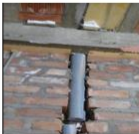
tubería por medio de la viga juntas mayores a 2.0 cm en murar partantor
