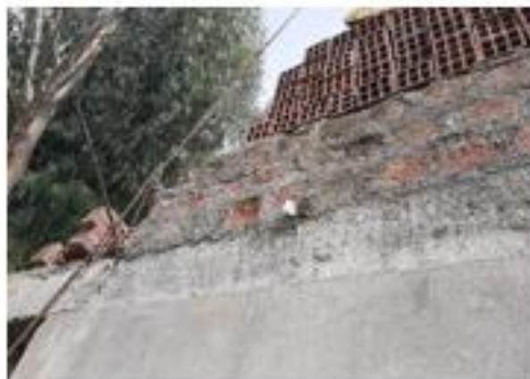
carracion de acero por expansion ladrillar crudo en pura partante dormaranamiento del ladrillo
