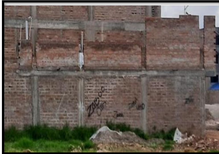
Figura 4.5 - Parapetos y muros del 2do nivel no arriostrados
