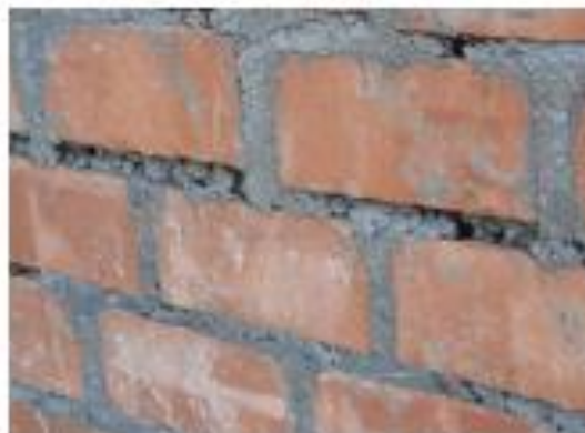
mala calidad de mano de obra
