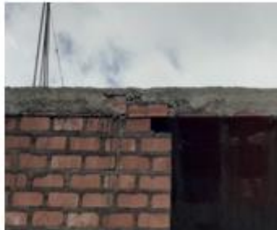
Ultima hilada de ladrillo no hay union con el techo para aligerado Junta de murar partantes variables mayor a 2 cm
