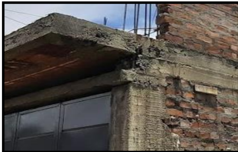
Figura 4.7 – Cangrejeras y exposición de varillas de acero.
