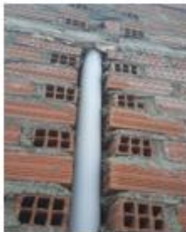
tubería descubierta en murar juntas mayores a 1.5 cm
