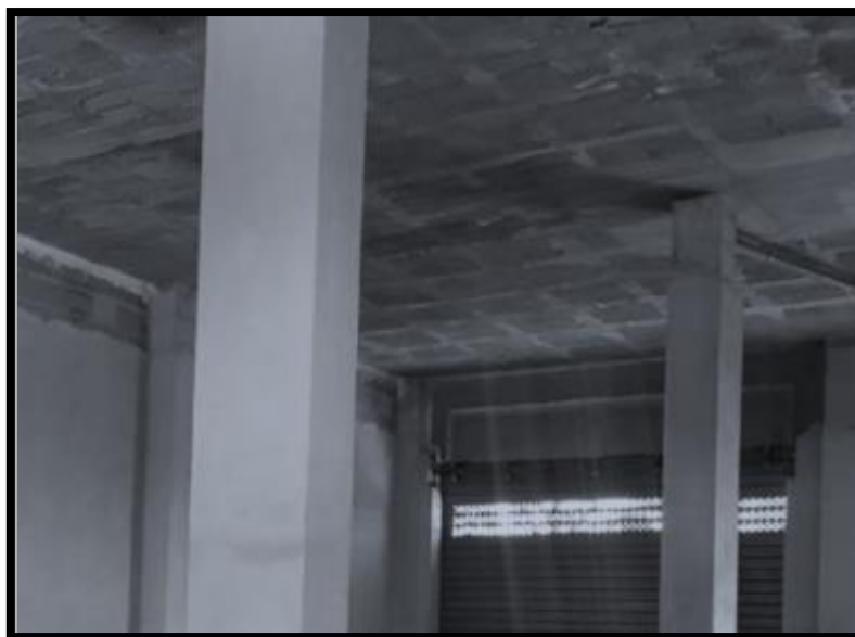
Figura 4.14 - Vivienda con densidad de muros inadecuada en el 1er nivel
