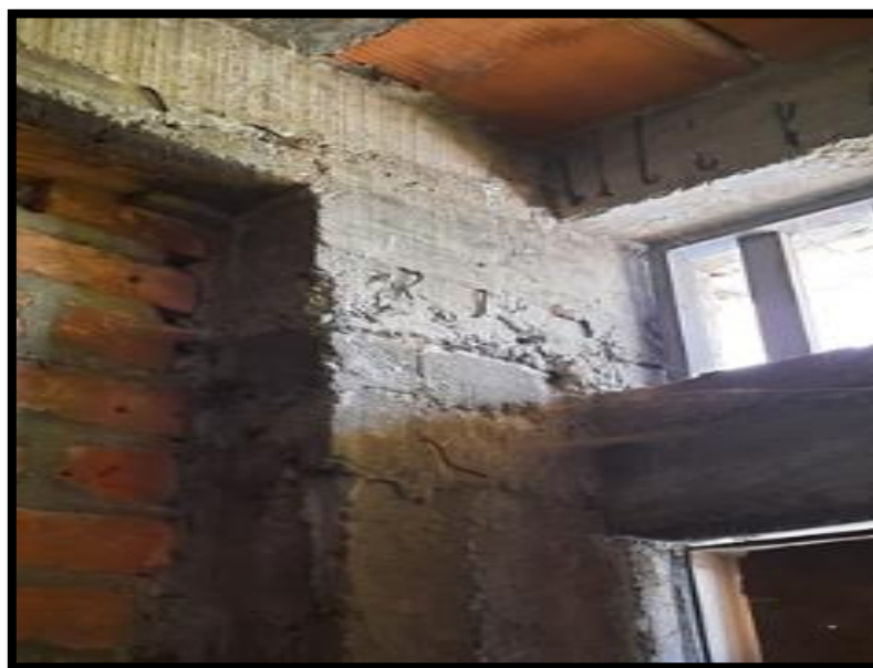
Figura 4.8 – Columnas con juntas de construcción (frías)
