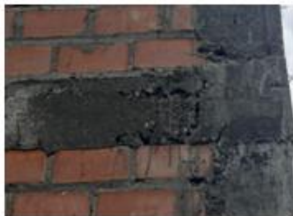
canquejar en vigas y columnar acera expuertas en las vigas debida a la presencia de canquejar
