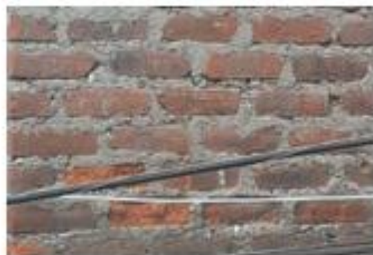
mala calidad de mano de obra en arriatado de muro juntas mayores a 3.0cm
