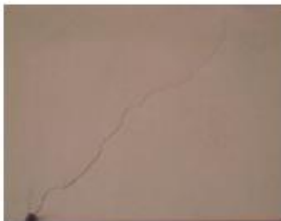
grieta en mura partante
