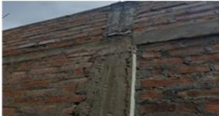
columna y muros deteriorados, ladrillo en mal estado
