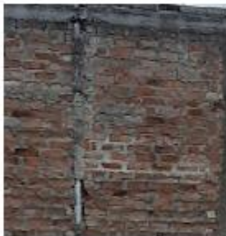
tuberia descubierta en murar
