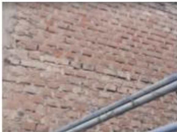
mala calidad de mano de obra en arenada de muro
