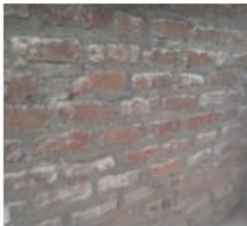
calidad de mano de obra mala juntas mayores a 3.0 cm
