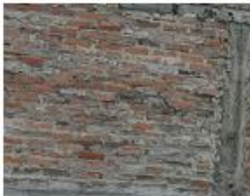
mala calidad de mano de obra juntas mayores a 2.0 cm
