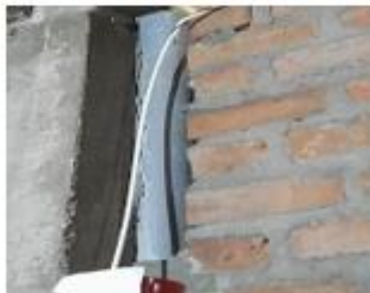
tubería descubierta en murar y columna mura partante no tiene arriartramiento
