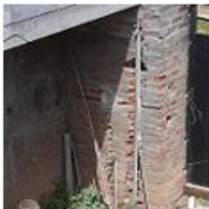
murar portante debilitado por corte para tuberia
