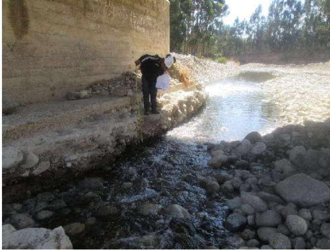
Foto 5: Muestra la toma de datos debajo del puente Santa Rosa de Ocopa, medición de socavación
