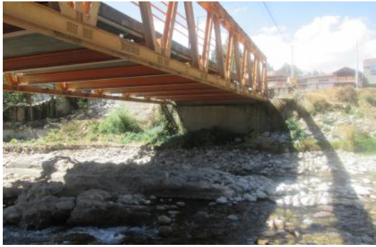
Socavacion de estribo de puente
