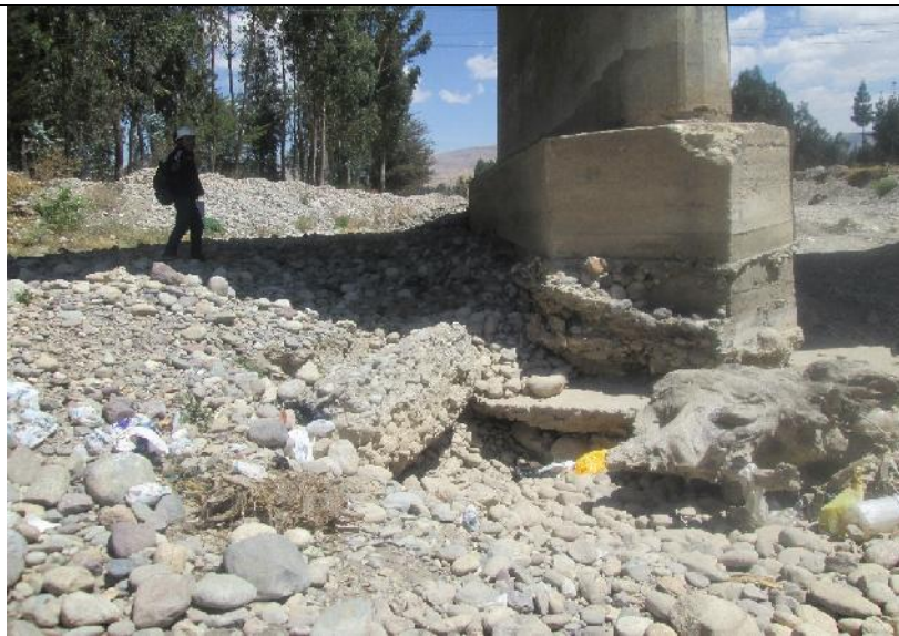
Foto 2: Se muestra la socavación del pilar del puente matahuasi
