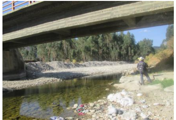
Socavacion de estribos de puente
