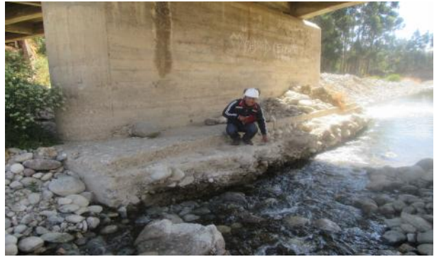
Socavacion de estribos de puente
