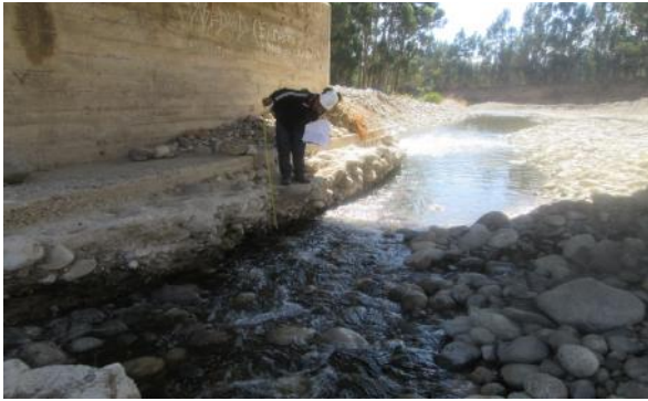
Socavacion de estribo de puente
