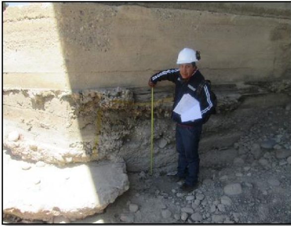
Socavacion de pilar central de puente
