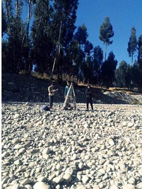
Foto 13: Trabajos de levantamiento topográfico de la sección de cauce en Rio Achamayo
