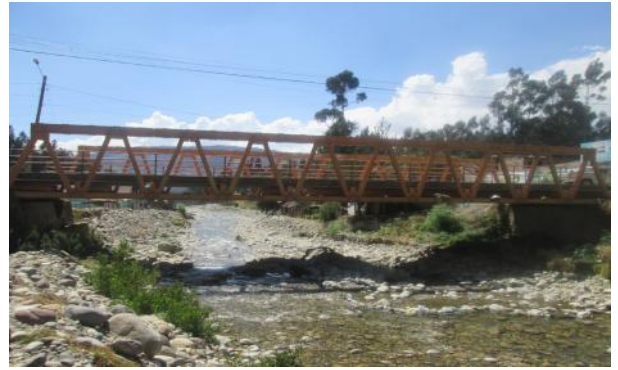
Socavacion de estribos de puente
