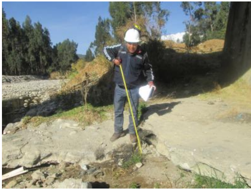
Socavacion de estribo de puente
