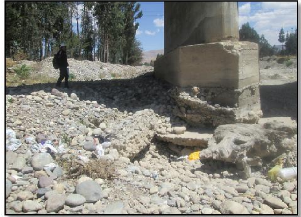
Socavacion de pilar central de puente
