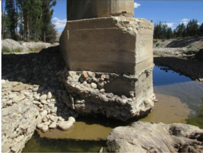
Foto 3: se muestra la socavación del pilar central del puente Matahuasi, se puede observar que hay una socavación producto de la extracción de agregados de la zona
