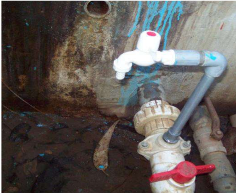
Figura 45 Vista de la instalación del grifo para la medición del cloro.
