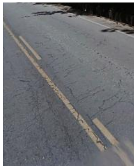
Foto 16. Pavimento deteriorado TRAMO IV 82+580
