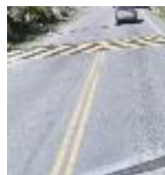
Foto 17. Pavimento con presencia de desgaste, pero en condición buena tramo V 84+430
