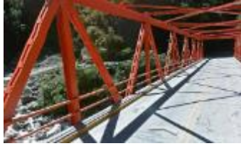
Foto 100. El ancho del puente es consistente con el ancho de calzada de la vía en el Km. 82+880.
