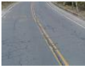
Foto 13. Pavimento deteriorado con presencia de piel de cocodrilo Tramo I 54+780
