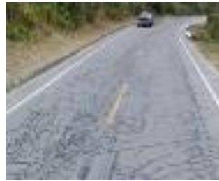
Foto 14. Pavimento con estado deteriorado en el Tramo II 57+266
