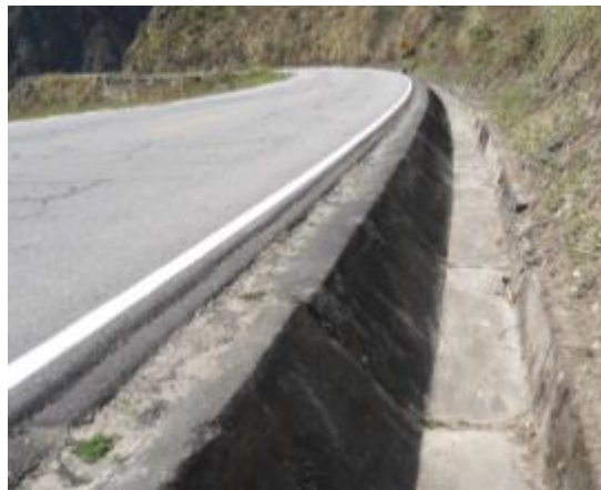
Figura 17: Cuneta profunda km 65+600
