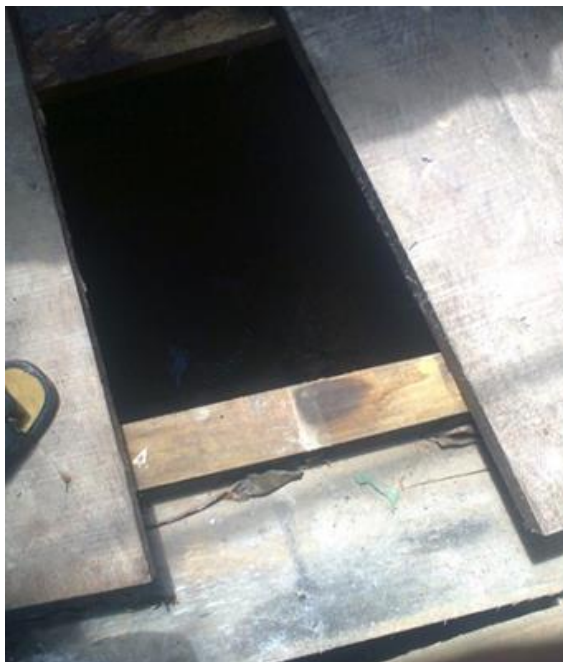
Figura 04. Se observa el mal estado en el que se encuentran las letrinas
