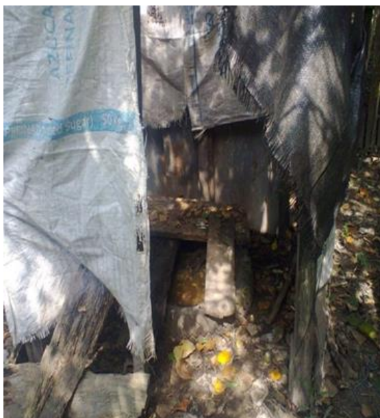
Figura 03. Deterioro de las letrinas en Villa Primavera
