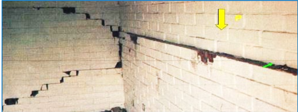
Figura 13: Falla por Deslizamiento.
