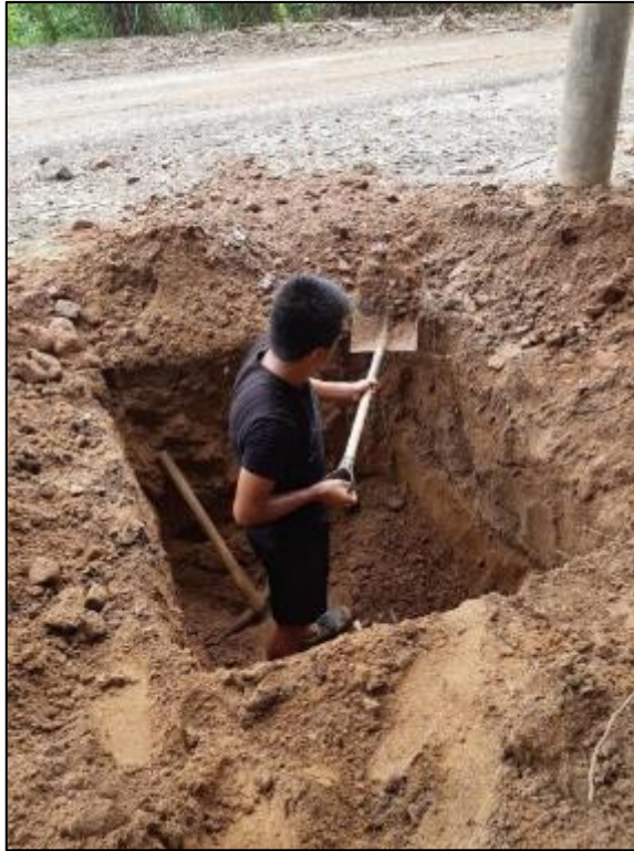
Figura 31. Excavación de suelo arcilloso en la sección de la subrasante Fuente: Elaboración propia
