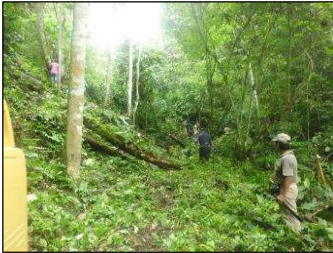
Fotografía 15.- Ubicación de la obra de arte hidraulica filtro lento
