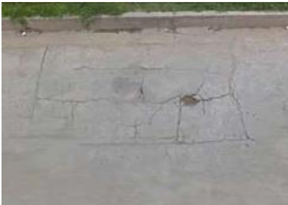
Figura 11 Agrietamiento en bloque del Jr. Alejandro Deústua tramo Av. Huancavelica – Jr. Sucre Fuente: Elaboración propia.
