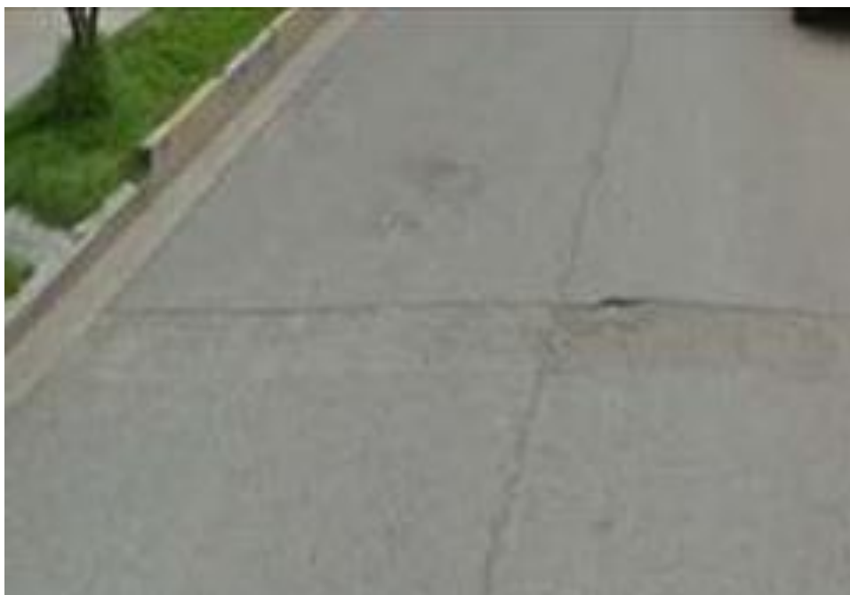
Figura 10 Piel de cocodrilo del Jr. Alejandro Deústua tramo Av. Huancavelica – Jr. Sucre Fuente: Elaboración propia.
