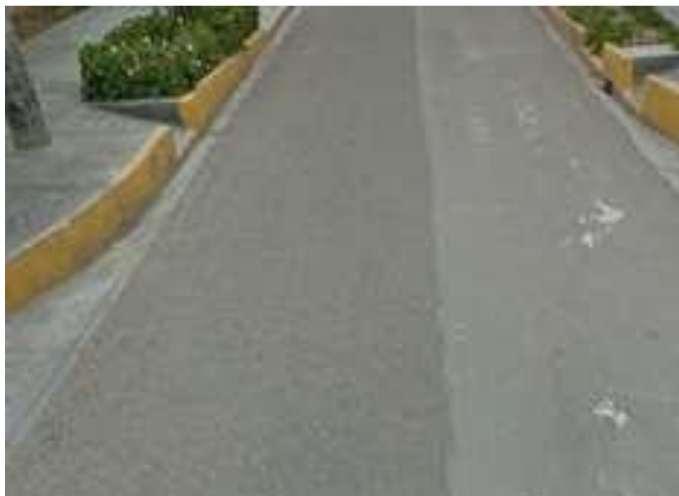
Figura 12 Desprendimiento de agregados del Jr. Alejandro Deústua tramo Av. Huancavelica – Jr. Sucre Fuente: Elaboración propia.
