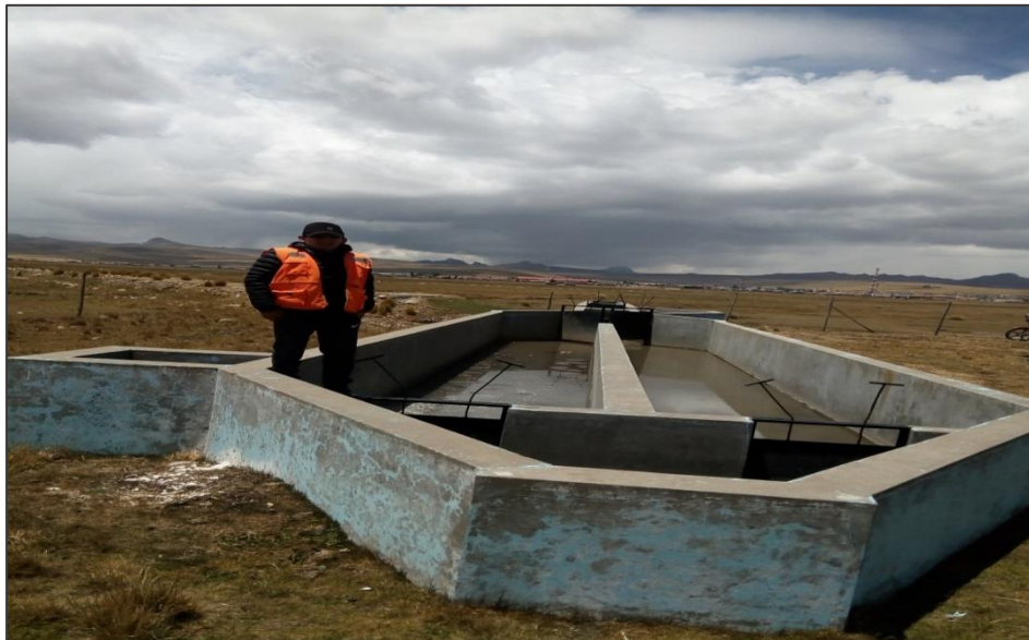
Fotografía N° 2: Se muestra el desarenador del PTAR de Junin
