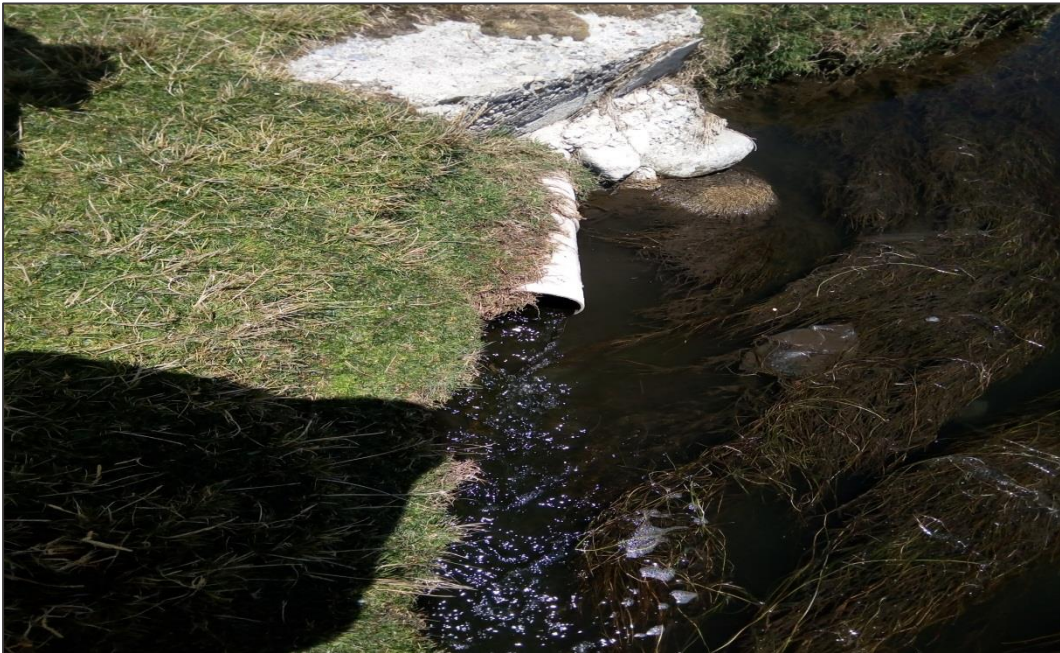
Fotografía N° 7: Descarga al Rio Chacachimpa una contaminación actual
