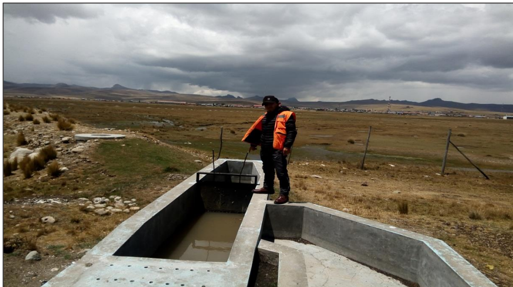
Fotografía N° 4: Ingreso de la cámara de rejas para el PTAR
