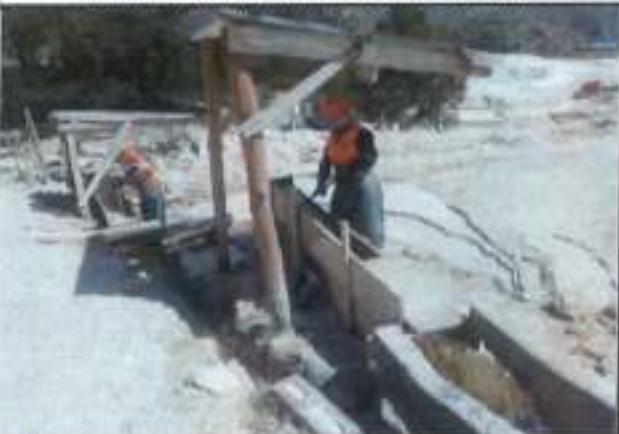
Canales hechos con agregado silíceo
