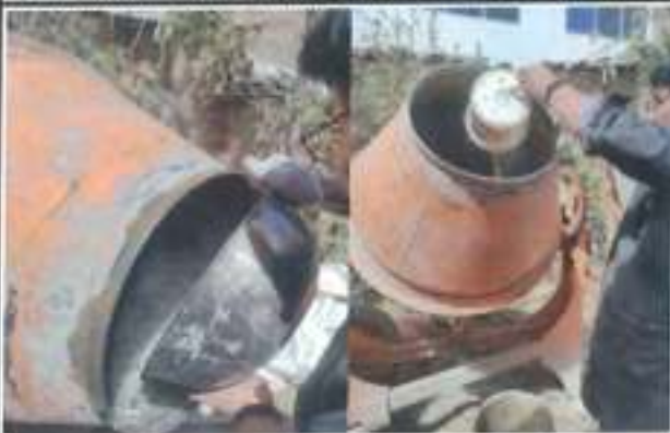
Antes de la rotación de la mezcladora se añade el arena gruesa (retenido de la N° 4) y una parte de agua.
