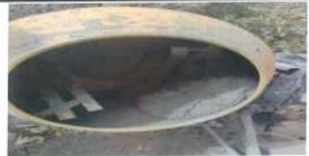
Después que todos los ingredientes están en la mezcladora, se mezclará el concreto durante 3 min seguidos, por 3 min de reposo y luego 2 min finales de mezclado. Se puede visualizar en la foto la mezcla al interior del trompo al incorporar el 15 % de agregado silíceo.
