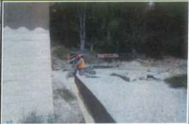
Canal que transporta en material a base de agua
