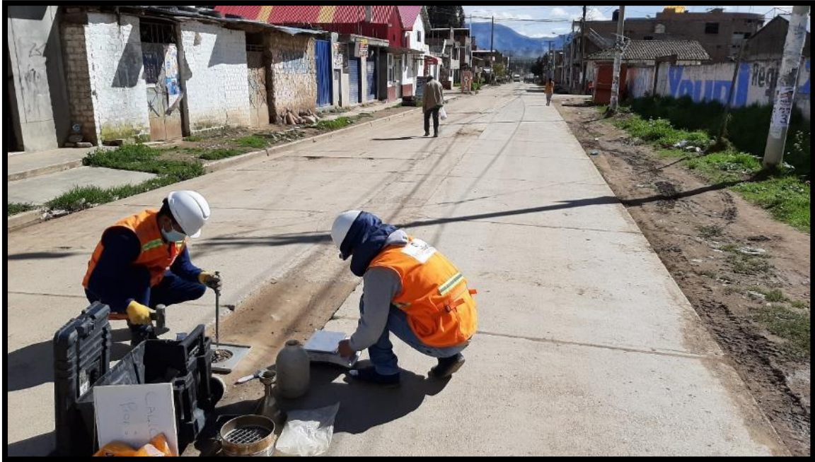
En la presente foto se observa la extracción de material compactado a nivel de base para la Densidad de Campo
