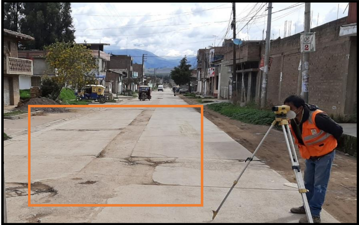
En la presente foto se observa el asentamiento del pavimento rígido de la Av. Alfonso Ugarte
