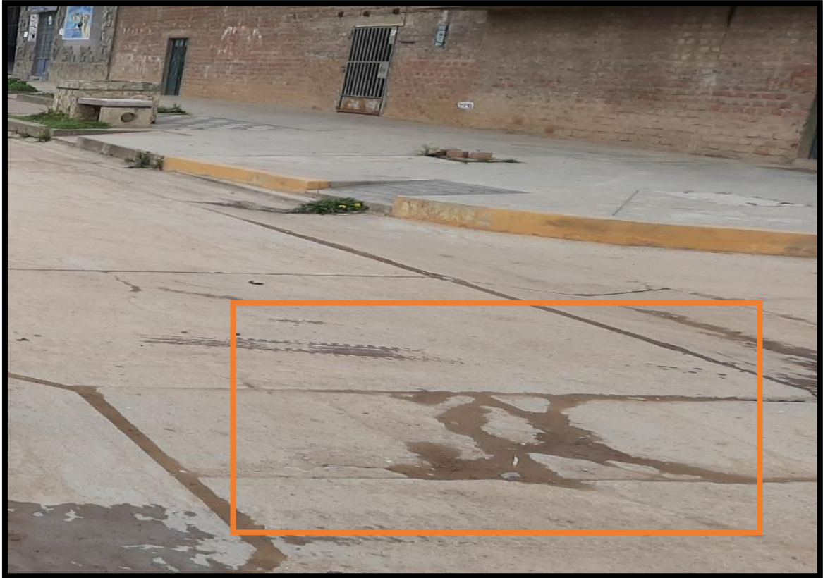
En la presente foto se observa el asentamiento del pavimento rígido de la Av. Alfonso Ugarte
