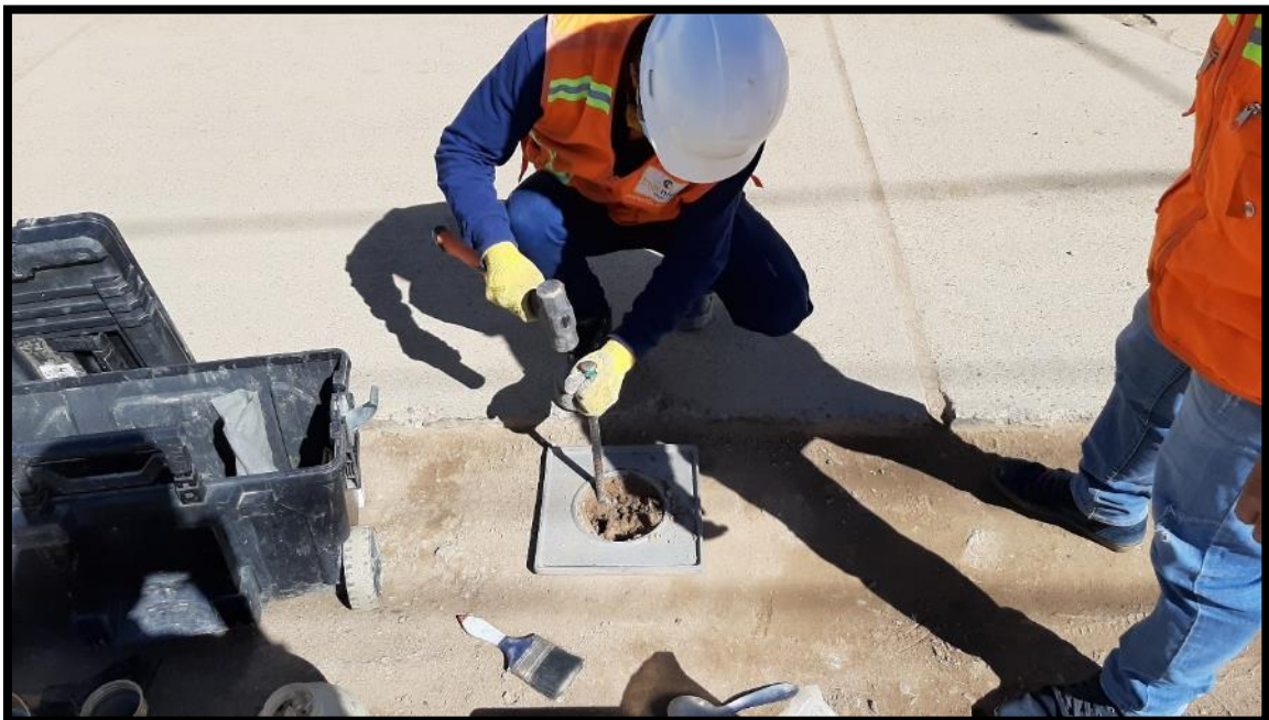
En la presente foto se observa la extracción de material compactado a nivel de base para la Densidad de Campo
