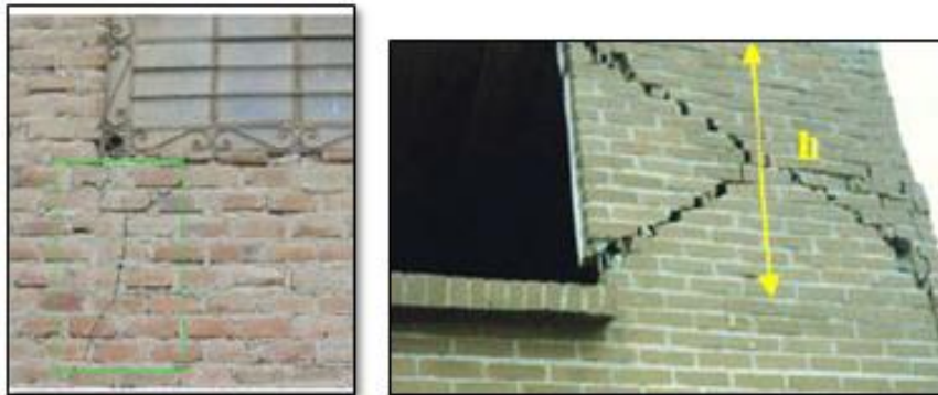
Figura 12. Grieta en el alfeizar y reducción en altura efectiva por efecto
