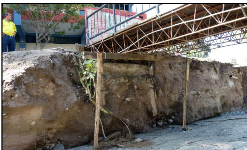
Figura 14. La inundación afecta la base del puente de la Universidad Nacional de Educación Enrique Guzmán y Valle.
