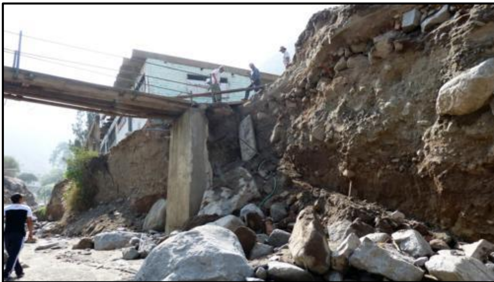
Figura 16. La falta de reforzamiento del puente peatonal se encuentra en peligro de colapso.
