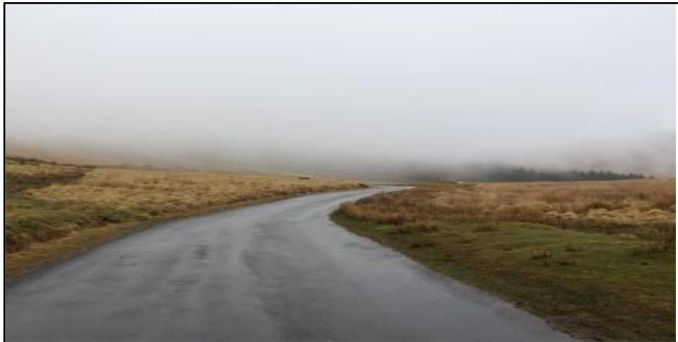
Figura 2. Carretera Huancavelica – Lircay sin Demarcación Vial Horizontal.
