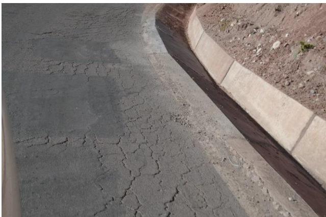
Foto N° 9. Estado de la demarcación lateral
