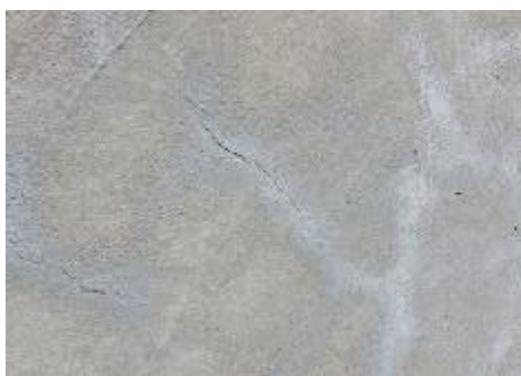
Figura. 1.1: Fisuras por retracción plástica Fuente: propia, 2022
