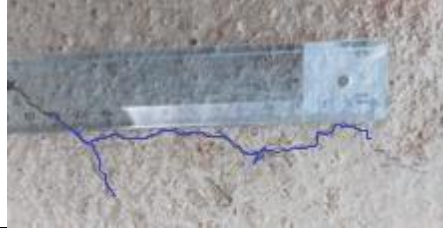
Fisuras más críticas. F.4
