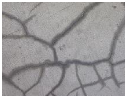
Figura. 1.2: Fisuras por retracción plástica
