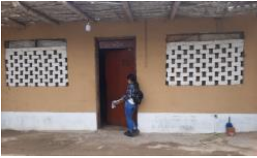
Recopilacion de informacion de campo de la edificacion N°7 de la calle Alfonso Ugarte lote 5, se aprecia vivienda de un piso, con ventana de ladrillo y techo de estera con soporte de bambu.
