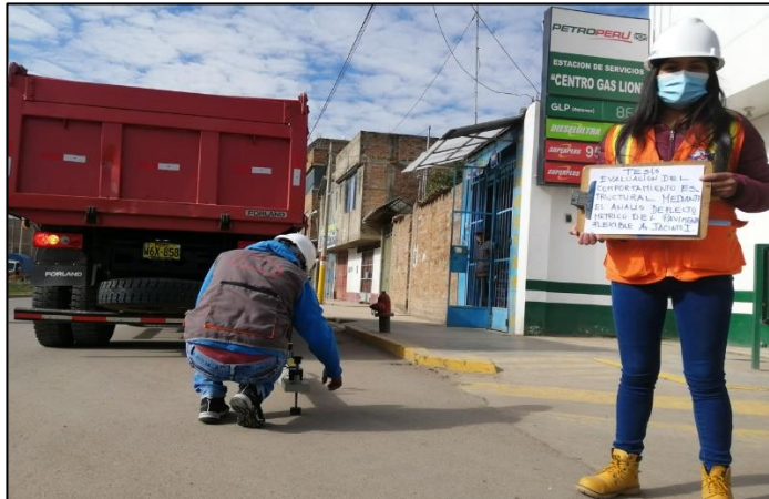
Fotografía 10. Colocación de la viga Benkelman en el punto a evaluar, Prog. 0+500 (ida).
