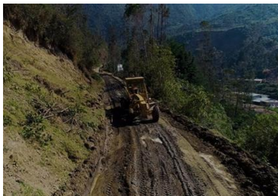
Figura 1. 1 Vista de la carretera Mallan Bajo en mal estado
