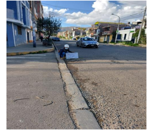
FOTO N° 9: SE OBSERVA LA FALLA SUPERFICIAL “PARCHE DETERIORADO”, CON SEVERIDAD BAJA Y EXTENSION DE 20% Y AREA DAÑADA - 1.93 M2
