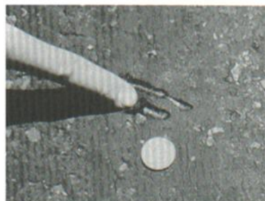
Figura A2-b. Exudación de severidad media.
