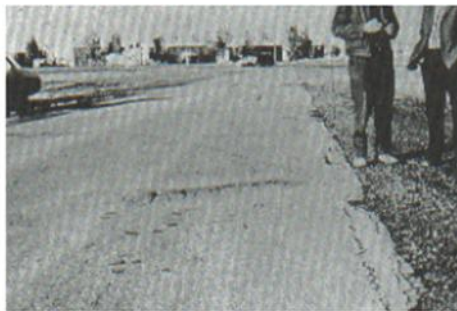
Figura A4-b. Abultamientos y hundimientos de severidad media.
