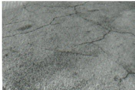
Figura A3-a. Grietas en bloque de baja severidad.
