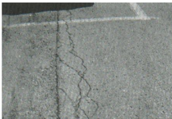
Figura A7-b. Grieta de borde de severidad media.
