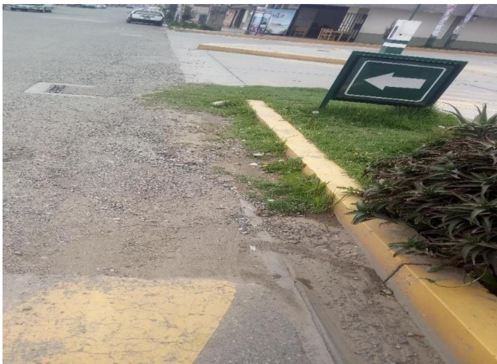
Figura 6. Cunetas saturadas y obstruidas por malezas.
