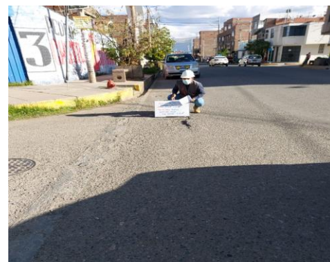
FOTO N° 5: SE OBSERVA LA FALLA SUPERFICIAL “HUNDIMIENTO”, CON SEVERIDAD MEDIA Y EXTENSION DE 20% - 50% Y AREA DAÑADA - 3.30 M2
