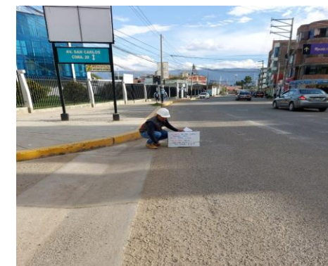
FOTO N° 6: SE OBSERVA LA FALLA SUPERFICIAL “ONDULACION”, CON SEVERIDAD MEDIA Y EXTENSION DE 20% - 50% Y AREA DAÑADA - 8.00 ML
