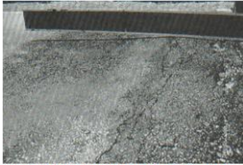
Figura A4-c. Abultamientos y hundimientos de alta severidad.
