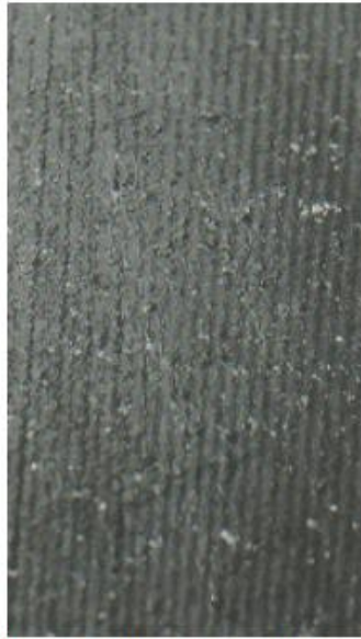
Figura A2-c. Exudación de alta severidad.
