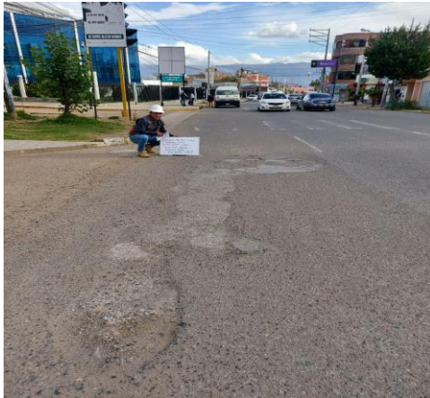
FOTO N° 7: SE OBSERVA LA FALLA SUPERFICIAL “PARCHE DETERIORADO”, CON SEVERIDAD ALTA Y EXTENSION DE 50% Y AREA DAÑADA - 33.00 M2
