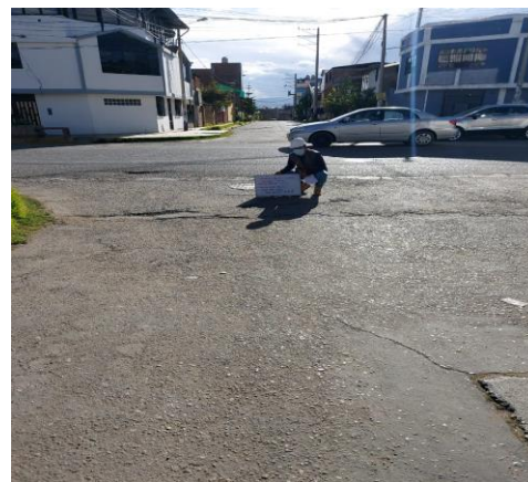
FOTO N° 2: SE OBSERVA LA FALLA SUPERFICIAL “BACHE”, CON UNA SEVERIDAD ALTA Y EXTENSION DE 50% Y AREA DAÑADA - 1.50 M2
