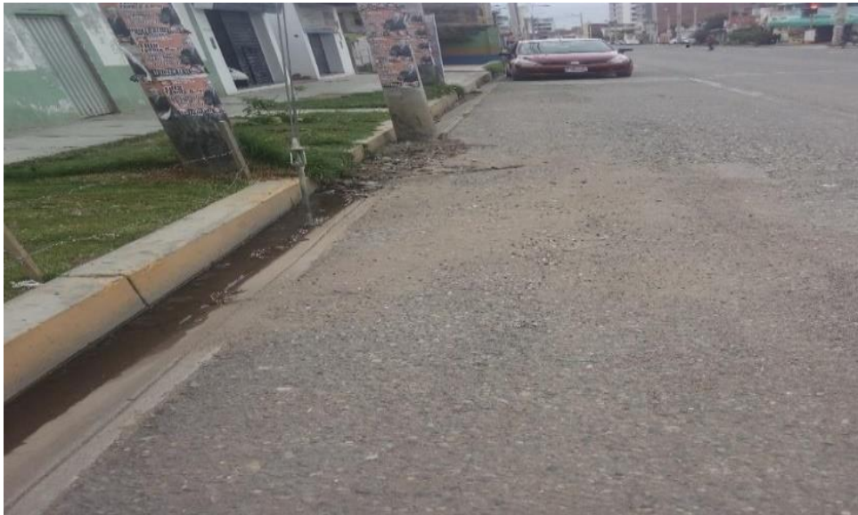
Figura 4. El agua pluvial no tiene a donde dirigirse por la inferencia de los agregados.
