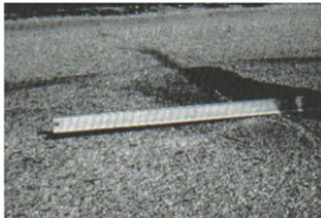
Figura A4-a. Abultamientos y hundimientos de baja severidad.
