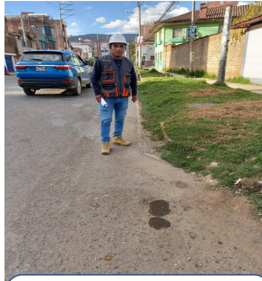
FOTO N° 2: SUMIDERO TAPADO POR EL CRECIMIENTO DE MALEZAS Y NO RECOLECTA EL AGUA PLUVIAL.
