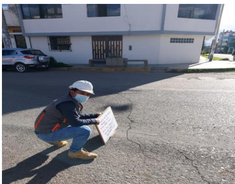
FOTO N° 4: SE OBSERVA LA FALLA SUPERFICIAL “FISURA TRANSVERSAL”, CON SEVERIDAD BAJA Y EXTENSION DE 20% Y AREA DAÑADA - 1.50 ML
