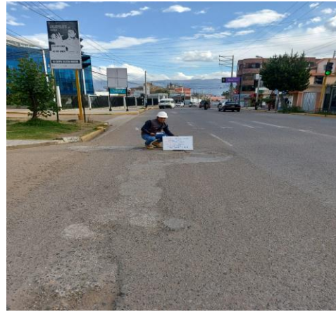
FOTO N° 8: SE OBSERVA LA FALLA SUPERIOR “FISURA TRANSVERSAL Y PERDIDA DE ARIDOS”, CON SEVERIDAD MEDIA Y EXTENSION DE 20% - 50% Y AREA DAÑADA - 3.30 ML - 38.30 M2
