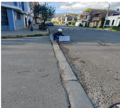
FOTO N° 1: SE OBSERVA LA FALLA SUPERFICIAL “BACHE”, CON UNA SEVERIDAD BAJA Y EXTENSION DE 20% Y AREA DAÑADA - 1.80 M2
