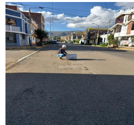
FOTO N° 3: SE OBSERVA LA FALLA SUPERFICIAL “PARCHE DETERIORADA”, CON SEVERIDAD MEDIA Y EXTENSION DE 20% - 50% Y AREA DAÑADA - 0.20 M2
