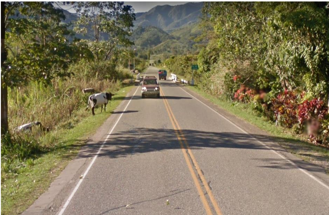
Fotografía N° 5: Vista en tramos que no cuentan con cunetas, y se observa su berma
