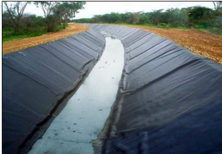
Figura 9. Canal revestido con geomembranas Fuente: (Abreu & Lara , 2015)
