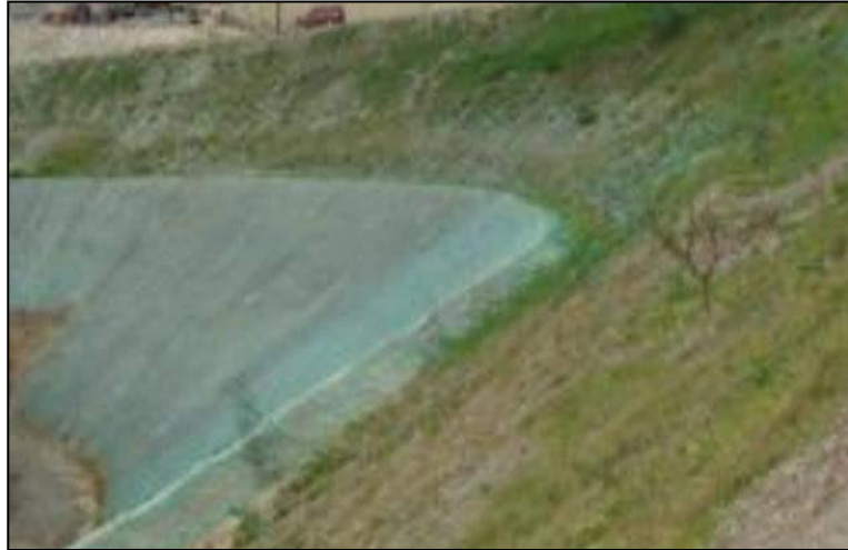
Figura 8. Canal revestido mantos permanentes Fuente: (IngeCivil, 2016)
