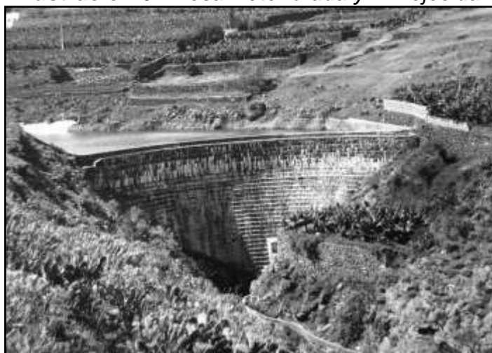
Ilustración 6. Presa Deteriorada y Envejecida
