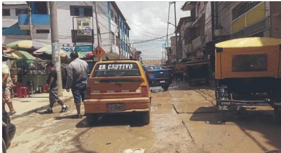
Figura 1. Estado de los pavimentos en la ciudad de Huancayo
