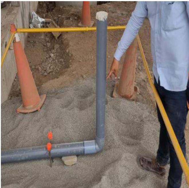
Instalación sanitaria para baño
