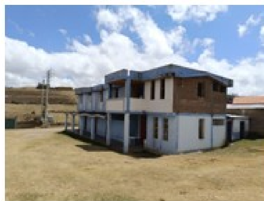
Imagen 26: Edificación comunal – Insostenible en todos los aspectos.
