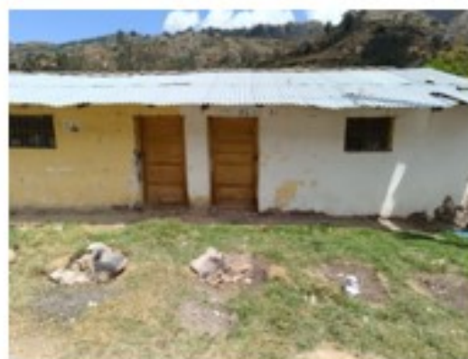
Imagen 24: Edificación comunal – Insostenible en todos los aspectos.
