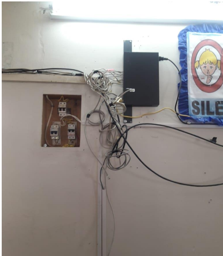
Ilustración 2: Switch de 10/100 con uso de cables UTP Cat 5E desordenados y sin protección.
