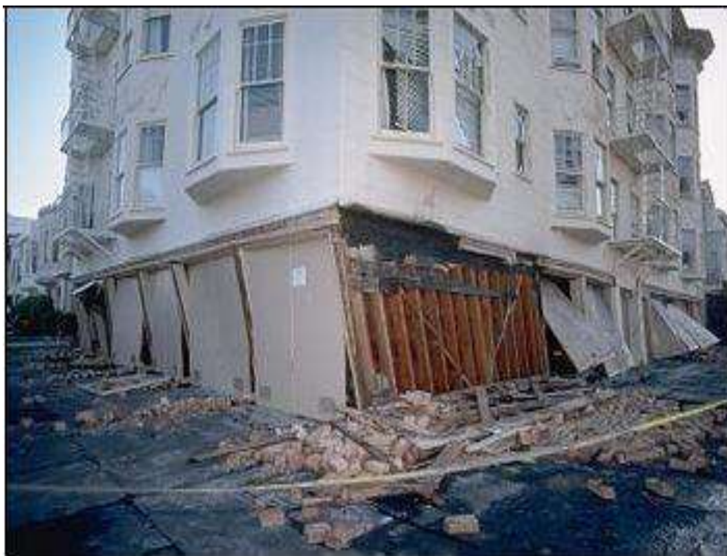
Figura 13: Edificio en San Francisco, California, después del terremoto de Loma Prieta Fuente: https://es.wikipedia.org/wiki/Refuerzo_antis%C3%ADsmico
